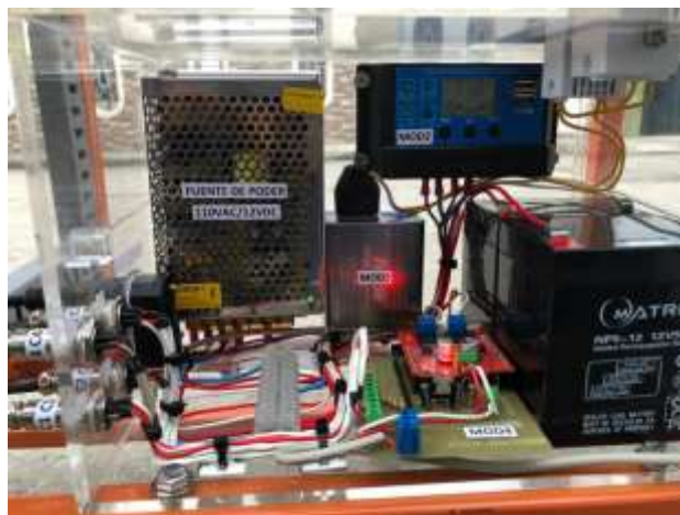
Figura 3. 10: Tablero del sistema de control del módulo solar fotovoltaico. Elaborado por: Autor.
