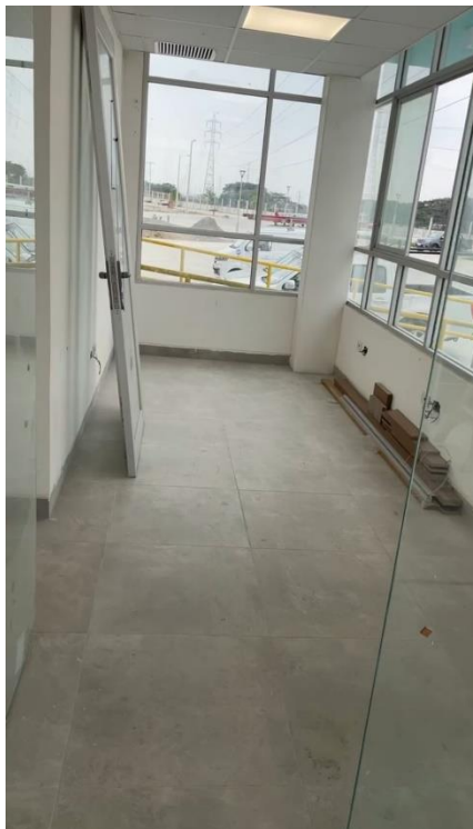
Figura AN 10: Planta baja de la empresa, donde en los planos indica que es el departamento de ventas. Fuente: Autor
