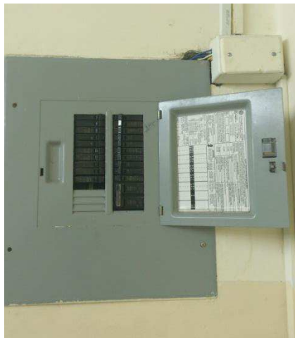
Figura 86.1-PD-1PA-1, Antes sin Marquillaje
