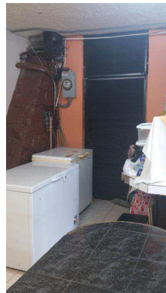
Figura 12.3-Entrada al Cuarto de Transformador
