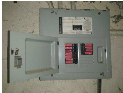
Figura 114.1-PD-SB-2, Antes sin Marquillar
