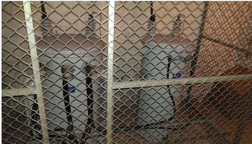
Figura 18-Falta de Fosos de aceite dieléctrico, Ubicado en el bar
