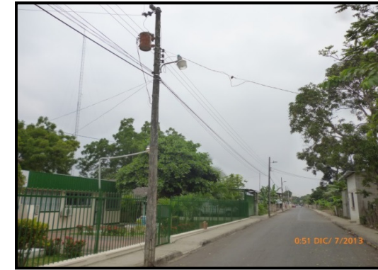
Figura 42: Imágenes del tendido eléctrico en el sector. Fuente: Mendoza (2014)
