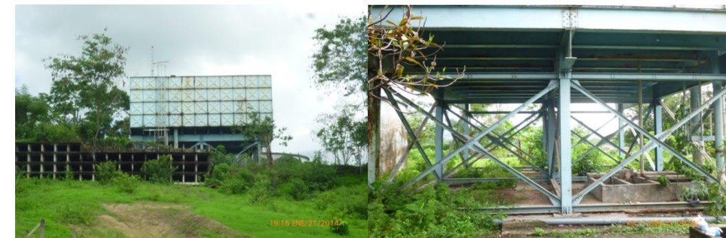
Figura 26: Tanque de almacenamiento de Agua potable de Calceta. Fuente: Mendoza (2013).
