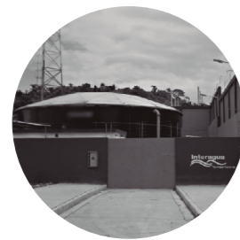
Bomba de abastecimiento de Interagua
