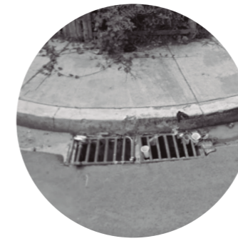
Estado actual de alcantarillado
