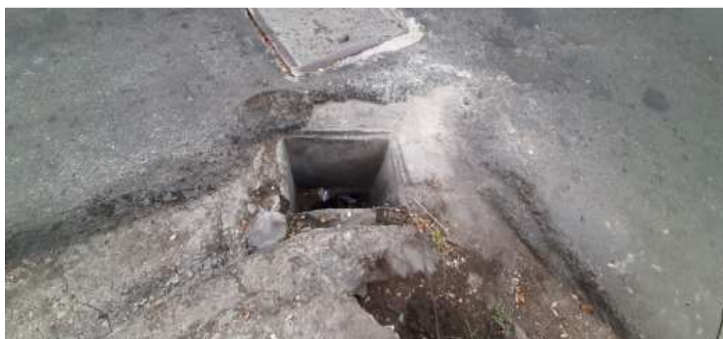
Ilustración 9. Sumidero sin Reja, Calle Jiguas y Jorge Maldonado Renella.
