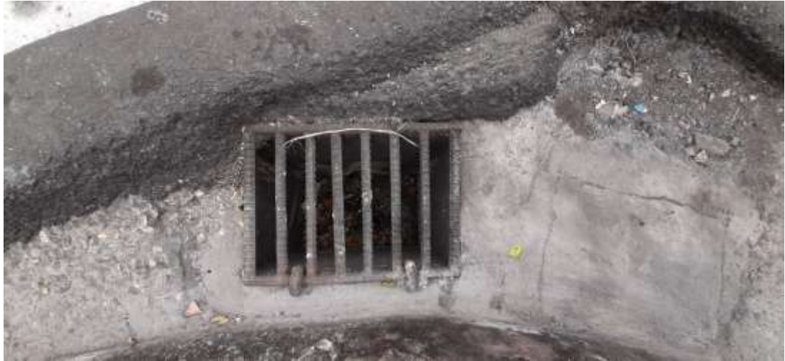
Ilustración 10. Sumidero con Residuos, Calle Jiguas y Bálsamos.
