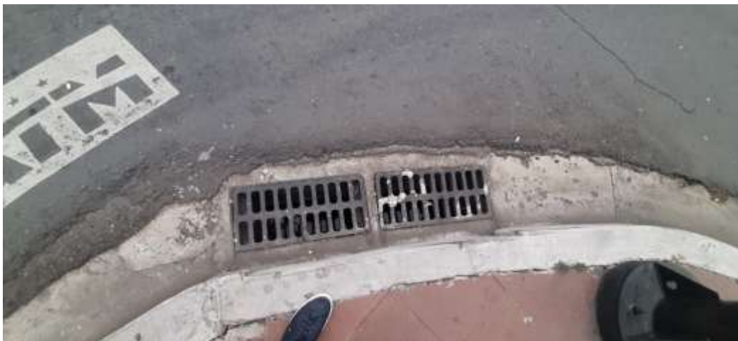
Ilustración 7. Sumidero de Reja Doble, Calle Jiguas y Av. Víctor Emilio Estrada.
