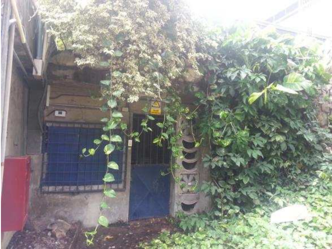
Figura 4. 2 Cuarto de Transformadores FUENTE: Autor
