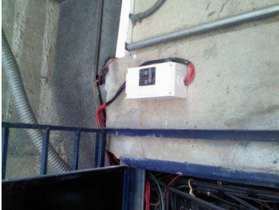
Figura 4. 8 Tablero de Distribución Principal ubicado en la Facultad de Arquitectura y Diseño FUENTE: Autor
