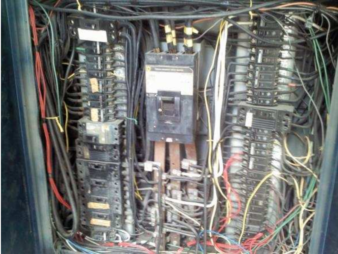
Figura 4. 6 Tablero de Distribución Principal de la Facultad de Arquitectura y Diseño FUENTE: Autor
