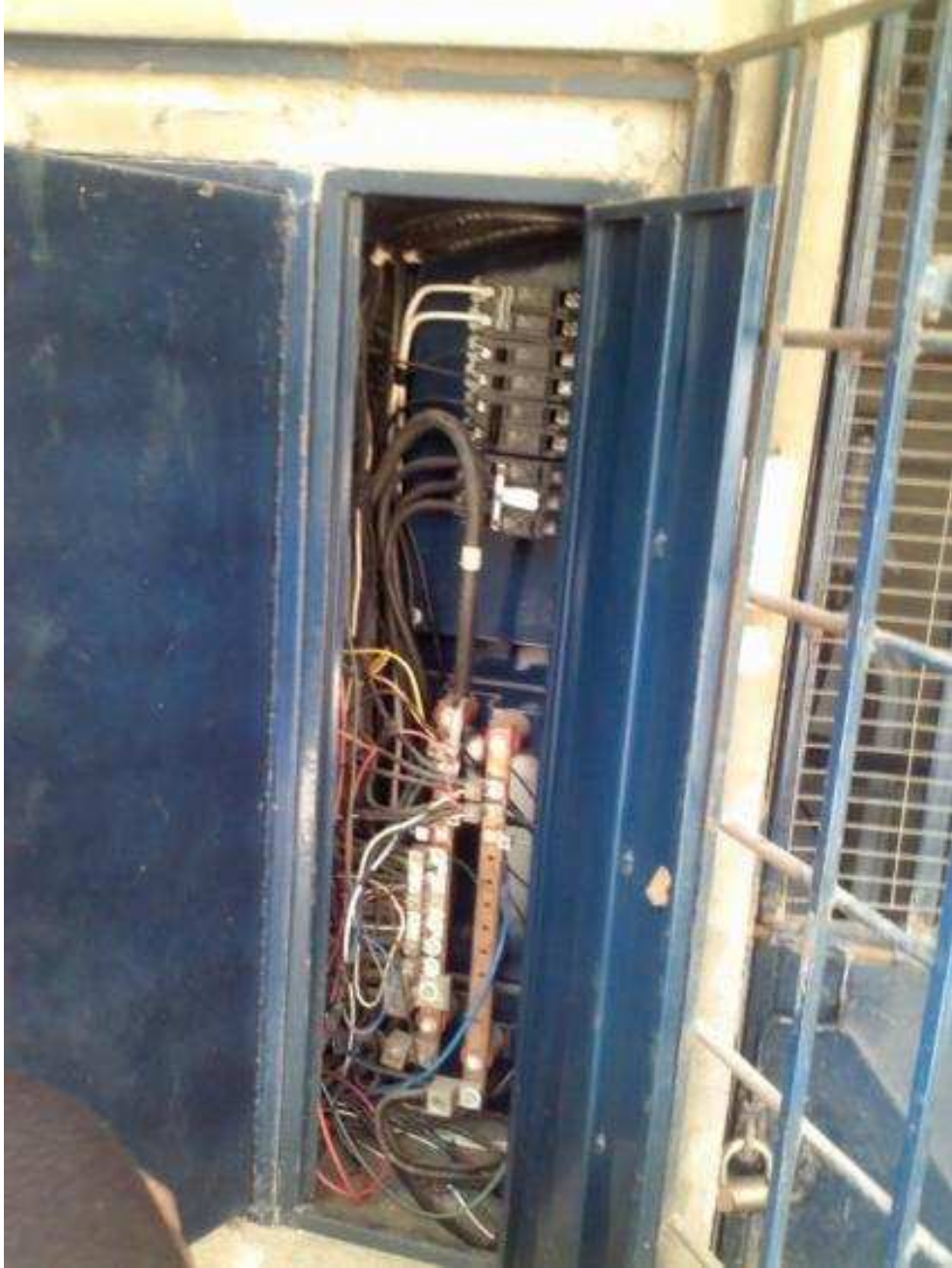
Figura 4. 7 Tablero de Distribución Principal Facultad de. Arquitectura y Diseño FUENTE: Autor
