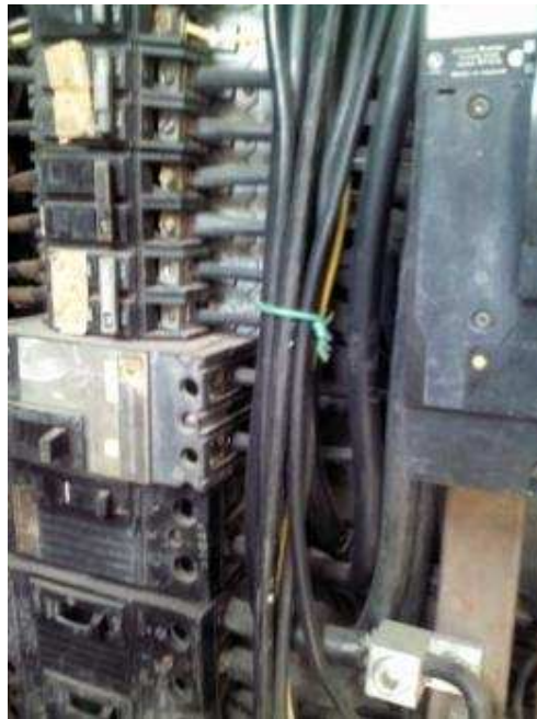
Figura 4. 9 Tablero de Distribución Principal de Facultad de Arquitectura y Diseño FUENTE: Autor
