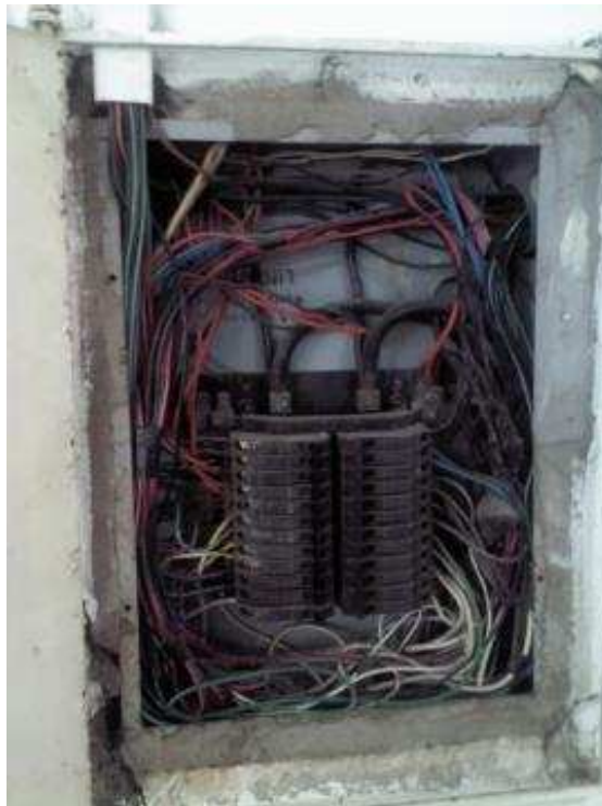
Figura 4. 14 Panel PB con vista de conexiones FUENTE: Autor
