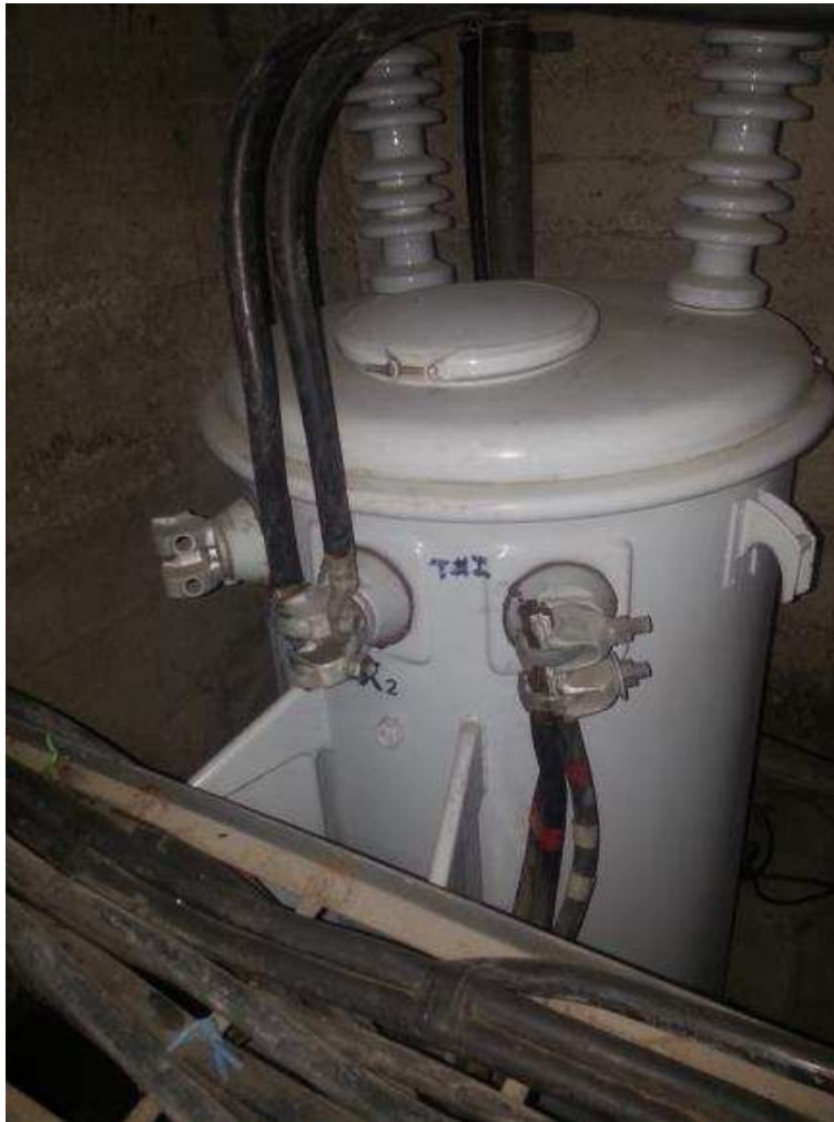
Figura 4. 5 Acometida en Baja Tensión Fac. Arquitectura y Diseño FUENTE: Autor
