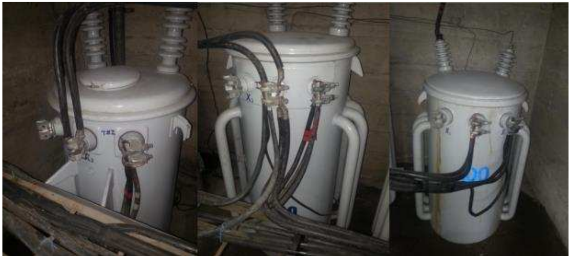
Figura 4. 4 Banco de Transformadores de 3x100 KVA Fac. Arquitectura Y Diseño FUENTE: Autor
