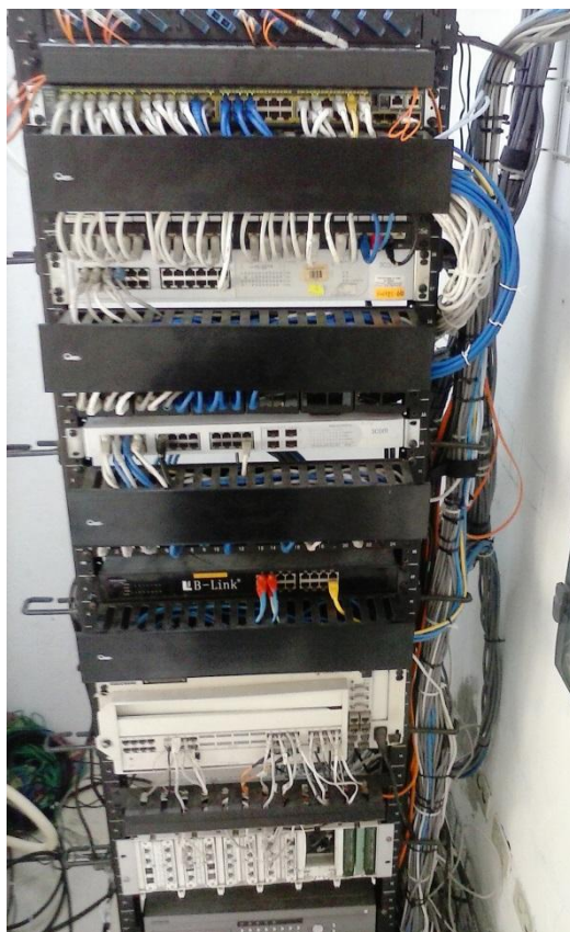
Figura 2.4 Rack principal de comunicaciones de la FET Fotografiado por: Autora
