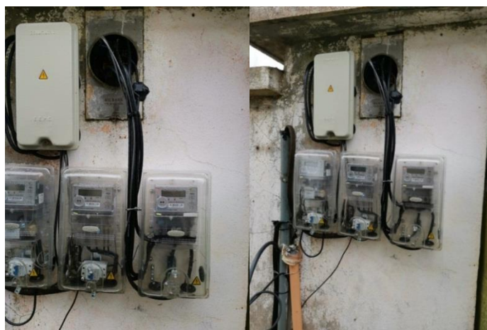
Figura 2. 25: Practica eléctrica de un medidor eléctrico. Fuente: (Mazur, 2014)
