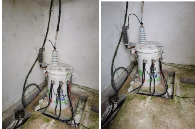
Figura 2. 20: Transformador eléctrico de potencia. Fuente: (Rodríguez Pozueta, 2018)
