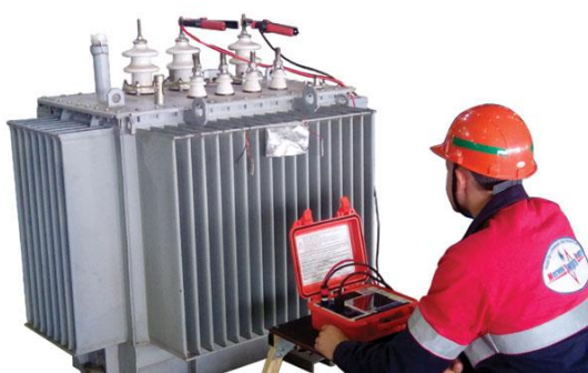
Figura 3. 1. Medición de Resistencia eléctrica en Transformadores. Fuente. (Domínguez, 2019)
