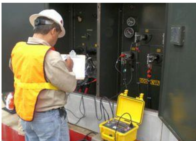
Figura 3. 2. Pruebas de Relación de Transformación Fuente. (Meprem Eléctrica S.A , 2022)
