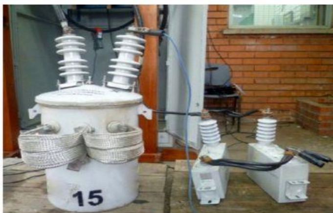
Figura 3. 3. Pruebas de Vacío en el Transformador. Fuente. (Meprem Eléctrica S.A, 2022)
