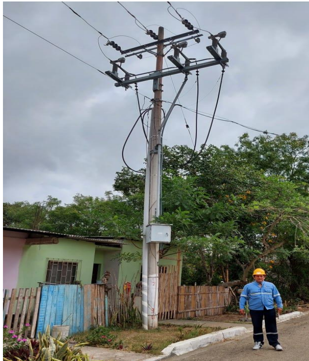
Anexo 10 Seccionadores monopolar de salida NC del alimentador Olón Fuente: El Autor.
