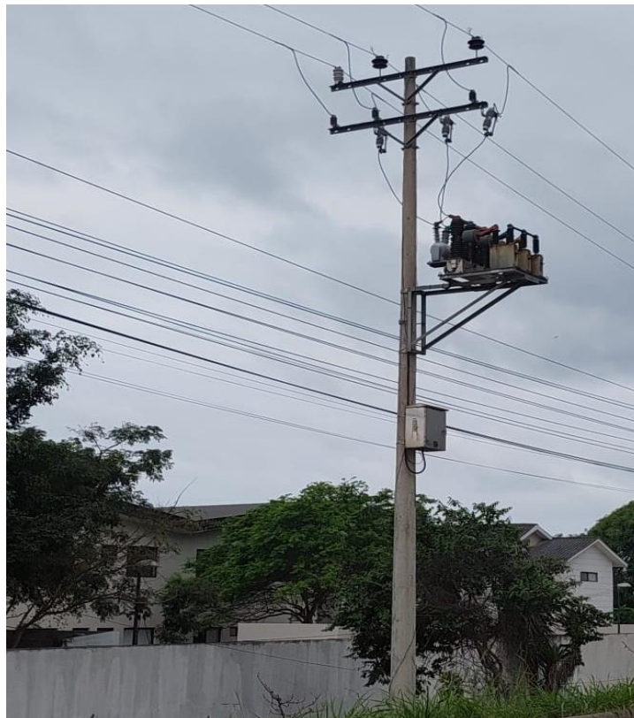
Anexo 16 Equipo de compensación banco de capacitor del alimentador Olón Fuente: El Autor.
