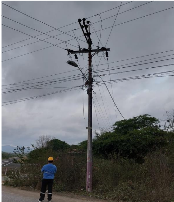
Anexo 12 Bypass transferencia "CTG" NC del alimentador Olón y Manglaralto Fuente: El Autor.
