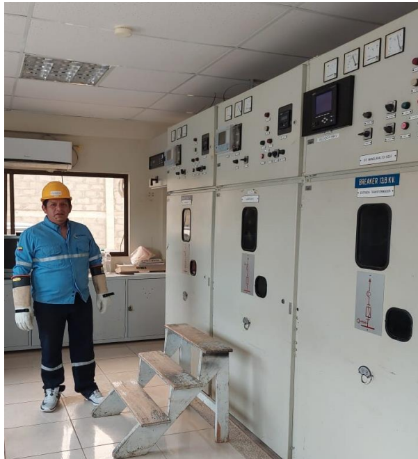
Anexo 9 Tablero de Alimentadores de la subestación Manglaralto Fuente: El Autor.
