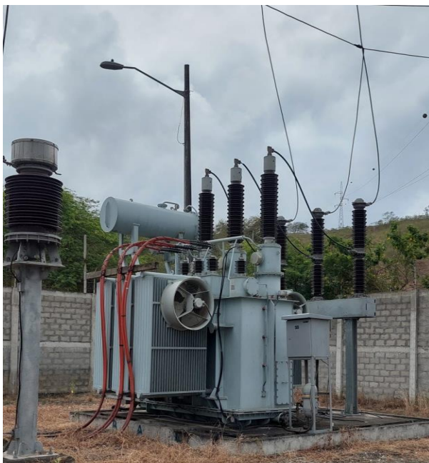
Anexo 7 Transformador de potencia de 69kv S/E Manglaralto Fuente: El Autor.
