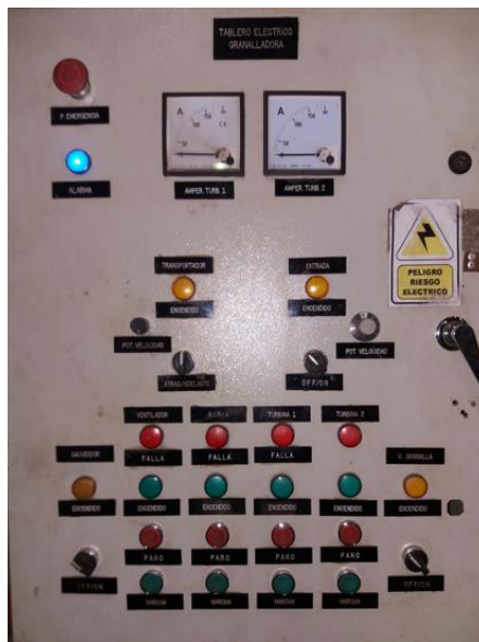
Figura 3.6 Cuadro de maniobra de Granalladora
