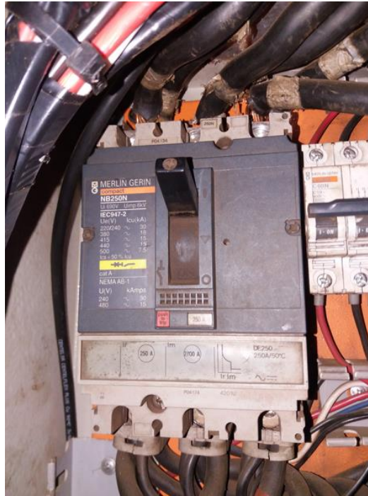
Figura 3.3 Breaker principal y cables de acometida de la Granalladora
