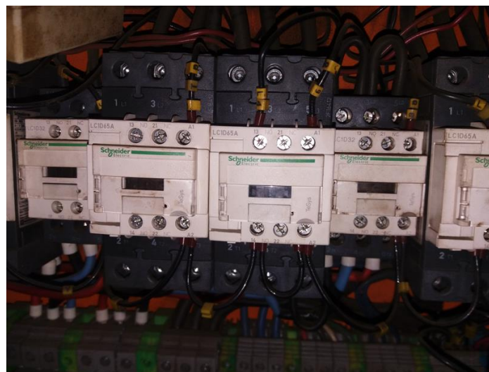
Figura 3.4 Contactores de motores de Turbinas
