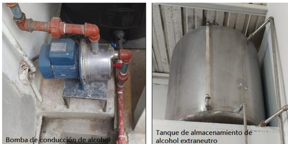
Figura 3. 16 Bomba de conducción y tanque de almacenamiento de alcohol extra neutro Fuente. El autor
