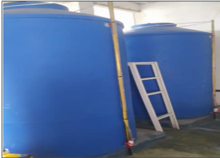
Figura 3. 15 Tanques de almacenamiento de alcohol
