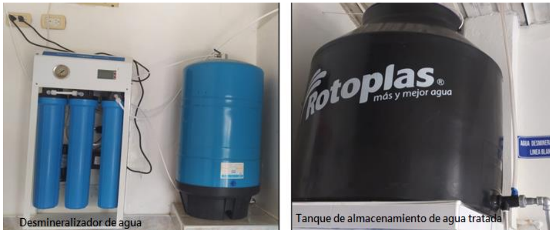
Figura 3. 17 Desmineralizador y tanque de almacenamiento de agua tratada
