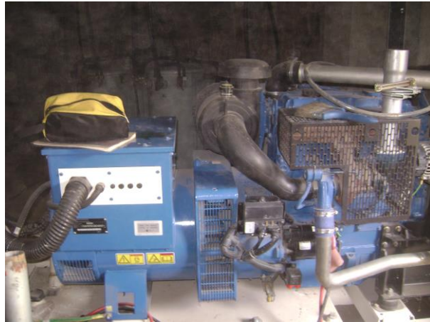
Figura 3.61. Generador de emergencia
