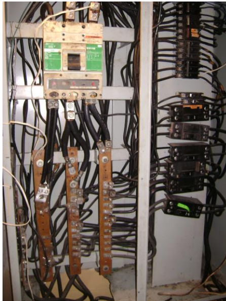
Figura 4.6. Breaker principal del banco de transformadores Y abierto aterrizado - \Delta abierto aterrizado
