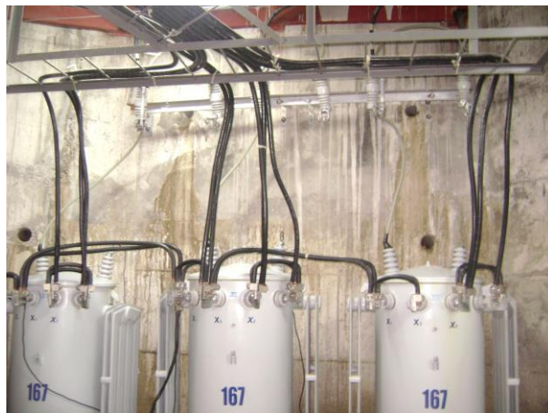
Figura 3.12. Acometida de media tensión al banco de transformadores trifásicos del edificio nuevo
