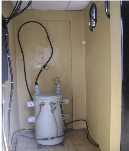
Figura 4.3. Acabado del mantenimiento del cuarto del transformador de Odontología
