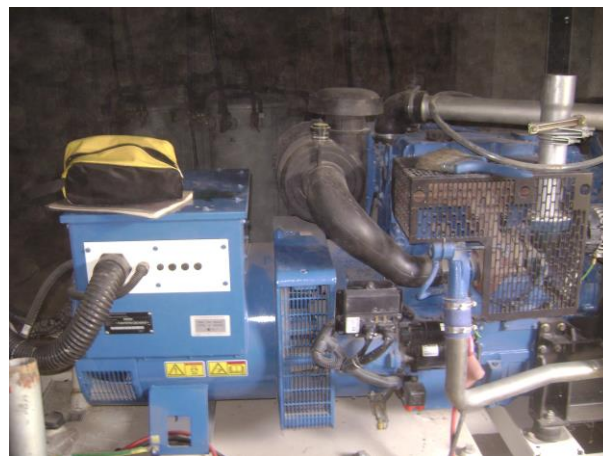
Figura 3.13. Generador de emergencia ubicado en el cuarto del banco de transformadores trifásicos del edificio nuevo
