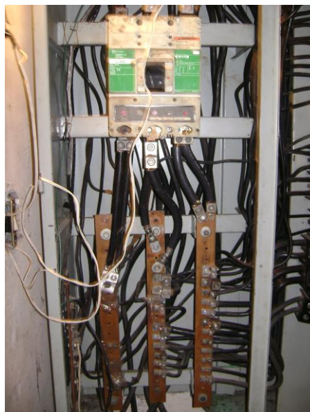
Figura 3.9. Breaker principal del banco de transformadores Y abierto aterrizado - \Delta abierto aterrizado
