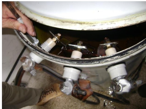
Figura 4.1. Ajuste de terminales de baja tensión del transformador de Odontología
