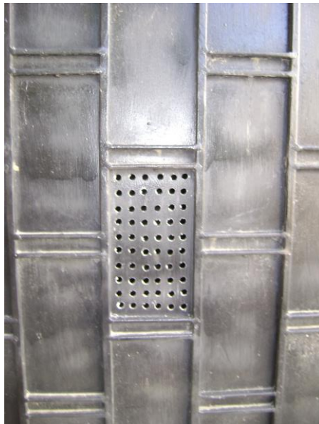
Figura 4.2. Inducción de flujo de aire en puerta de ingreso al transformador de Odontología
