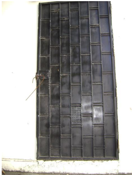
Figura 3.5. Puerta de acceso sin seguridad al cuarto de transformador de Odontología
