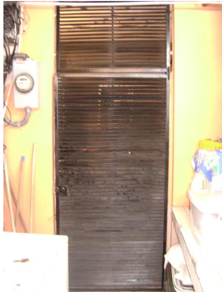
Figura 3.7. Puerta de acceso al banco de transformadores Y abierto aterrizado - \Delta abierto aterrizado
