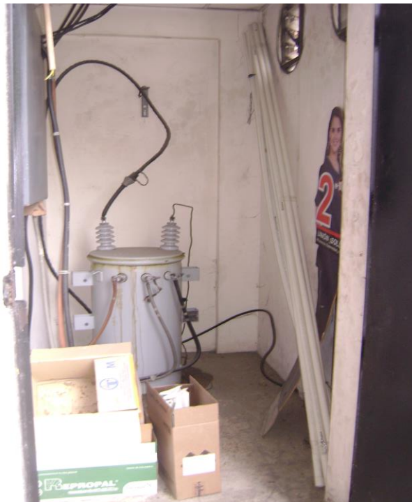
Figura 3.1. Cuarto de transformador de Odontología
