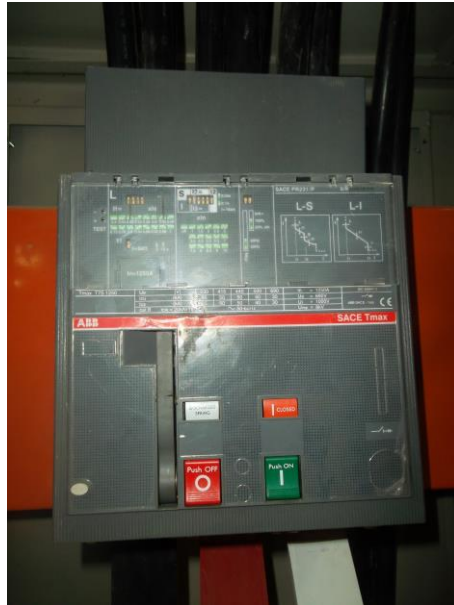
Figura 4.8. Breaker principal del tablero de distribución del cuarto de transformadores trifásicos
