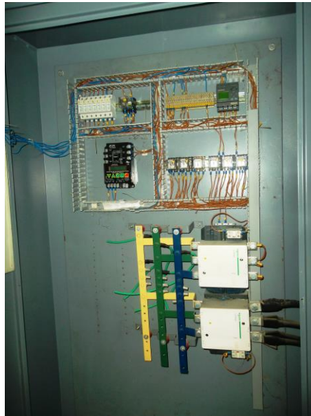
Figura 3.64. Panel de transferencia del generador sin conexión
