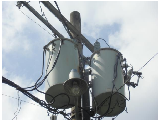
Figura 3.18. Líneas de distribución en baja tensión de los transformadores en poste #39
