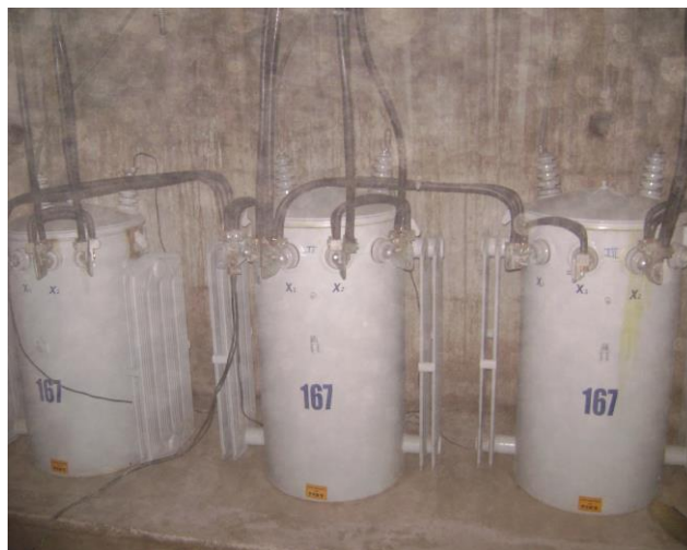
Figura 3.11. Banco de transformadores trifásicos del edificio nuevo
