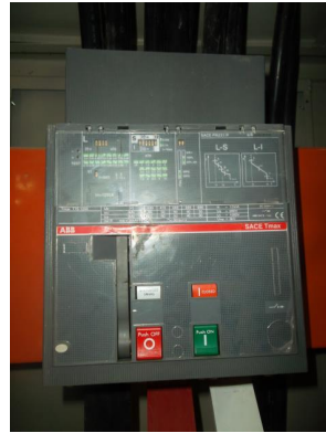
Figura 3.14. Breaker principal del banco de transformadores trifásicos del edificio nuevo
