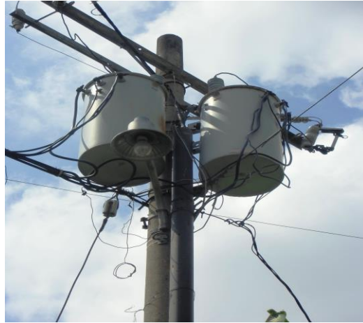
Figura 3.15. Transformadores idénticos monofásicos de distribución en el poste #39
