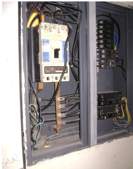
Figura 3.4. Breaker principal del tablero de distribución del cuarto de transformador de Odontología
