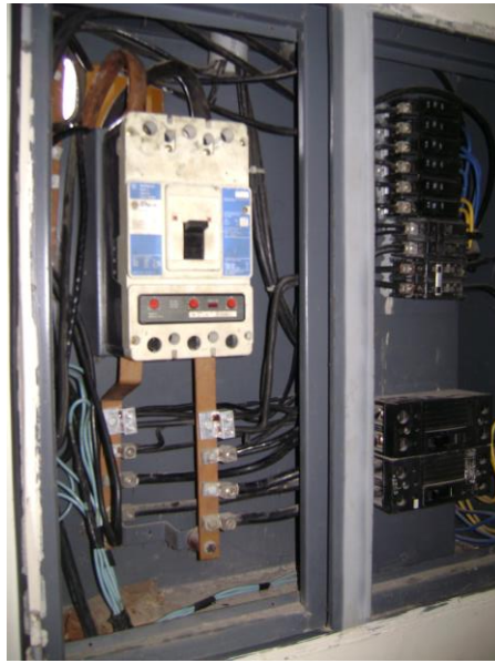
Figura 4.4. Breaker principal del cuarto del transformador de Odontología
