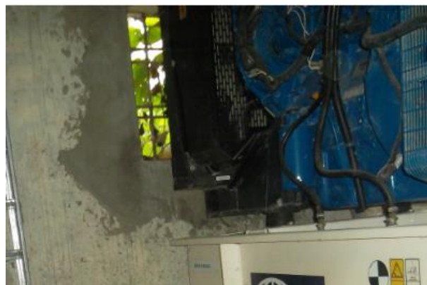
Figura 3.63. Ventilación externa del radiador del generador
