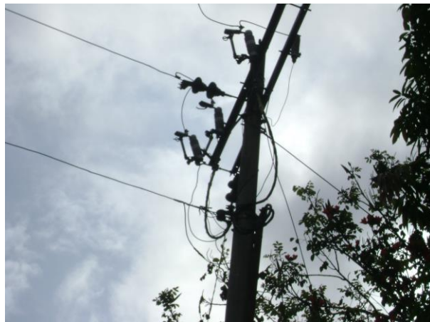
Figura 3.8. Acometida de media tensión al banco de transformadores Y abierto aterrizado - \Delta abierto aterrizado
