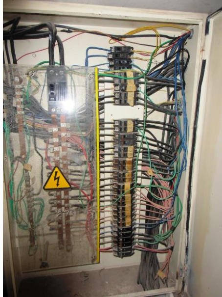
Figura 3.16. Breaker principal del Transformador_1 de 50KVA en Poste #39
