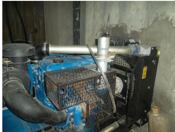
Figura 3.62. Generador sin salida de escape instalado
