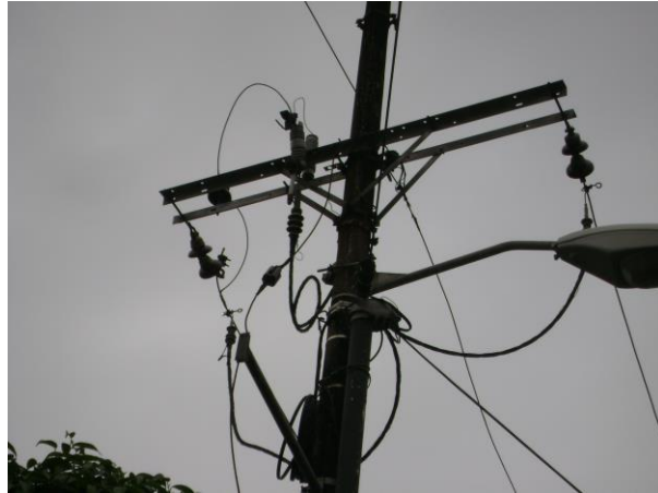
Figura 3.3. Acometida de media tensión al cuarto de transformador de Odontología
