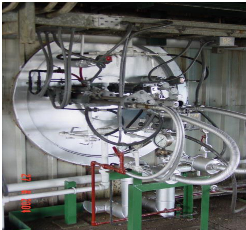
Figura 3.11.2 Presentación exterior de un quemador de una caldera acuotubular. Fuente: Central Trinitaria. (Cortesía)
