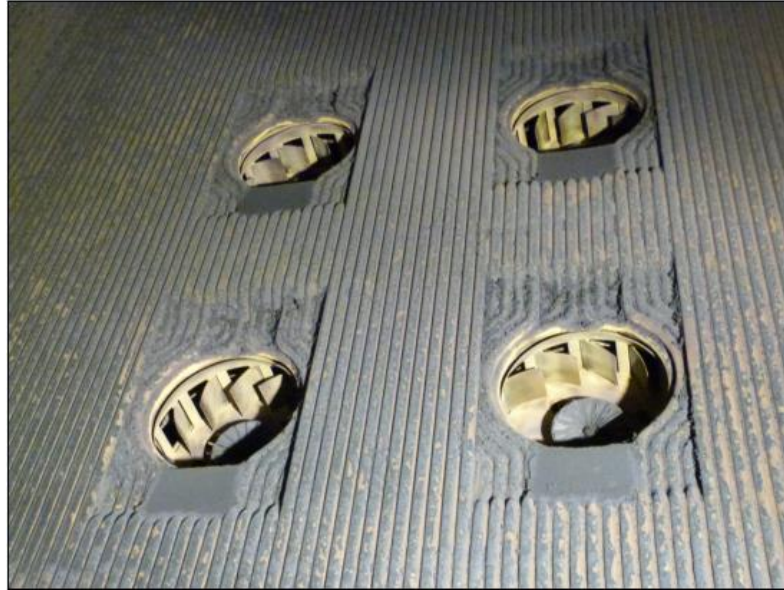
Figura 3.7.2 Paredes de agua de una caldera acuotubular Fuente: Cortesía Central Trinitaria
