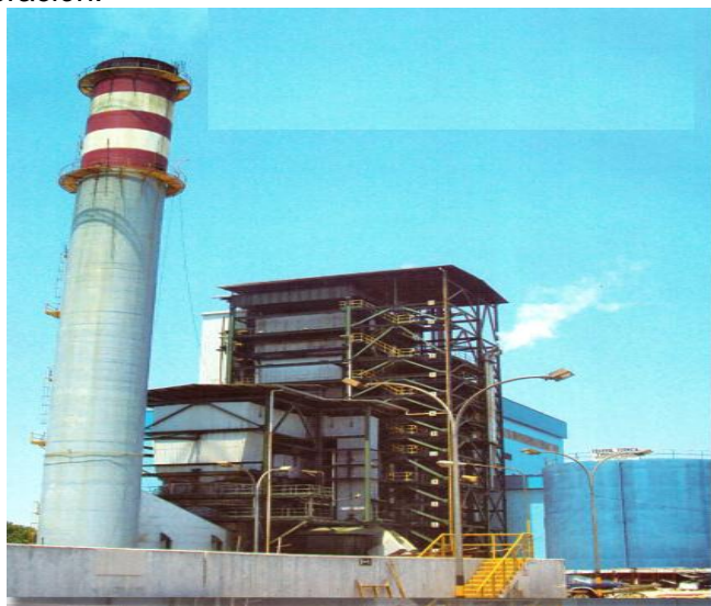
Figura 3.17 Vista de una caldera acuotubular Fuente: Central Trinitaria (Cortesía)
