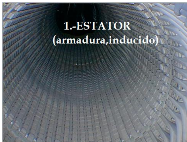
Figura 6.4 Estator Fuente: Central Trinitaria. (Cortesía)
