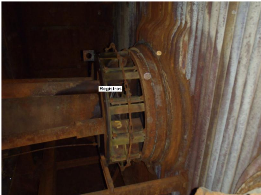
Figura 3.12.2 Vista de caja de aire y registros
