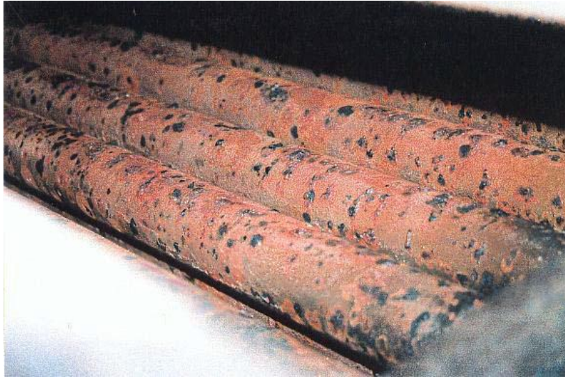
Figura 7.1 Corrosión por oxígeno. Fuente: (Thermal Engineering LTDA., 2007)
