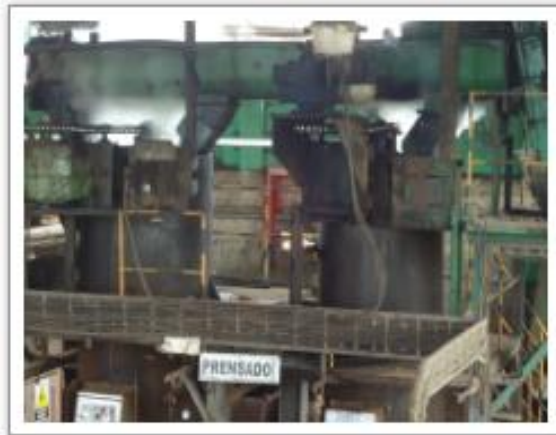
Figura 14. Digestores y Prensas.
