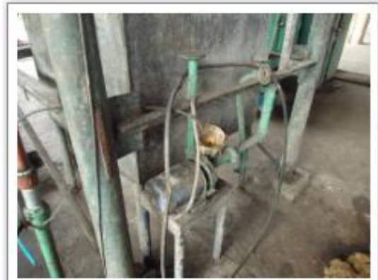
Figura 26. Tanque de Purgas.
