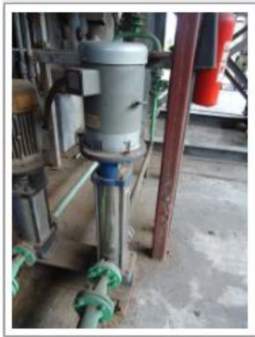
Figura 60. Bomba de Agua.
