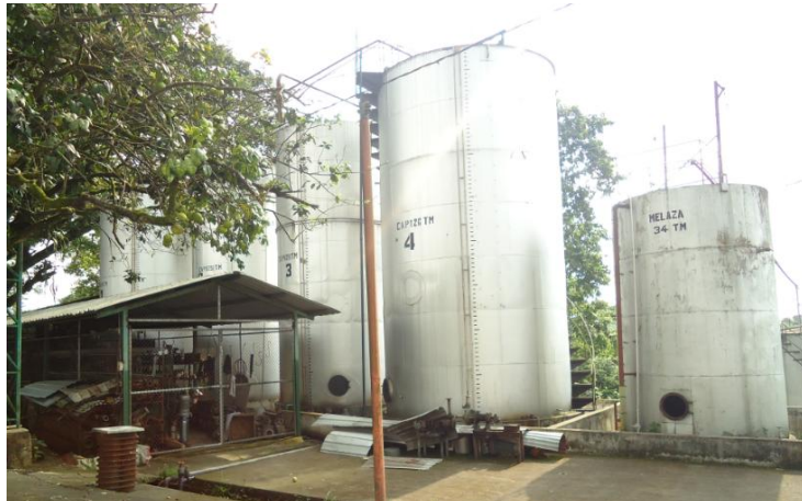
Figura 21. Tanques de Almacenamiento.
