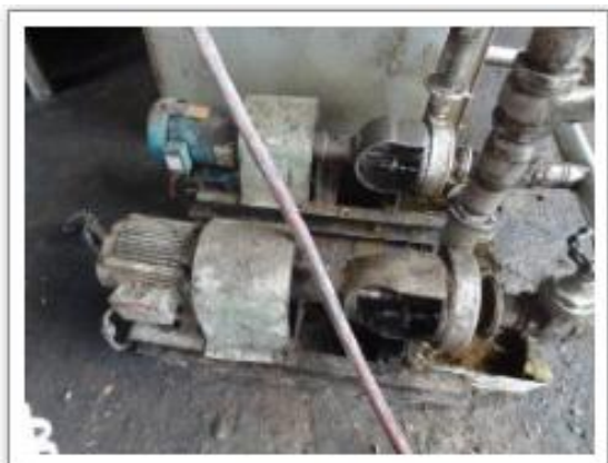
Figura 47. Bomba de Lodos.
