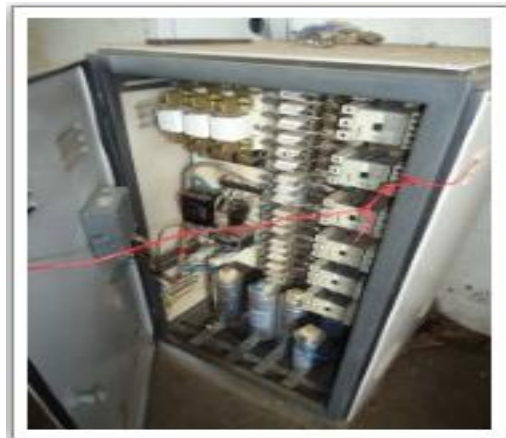
Figura 53. Banco de Capacitores.
