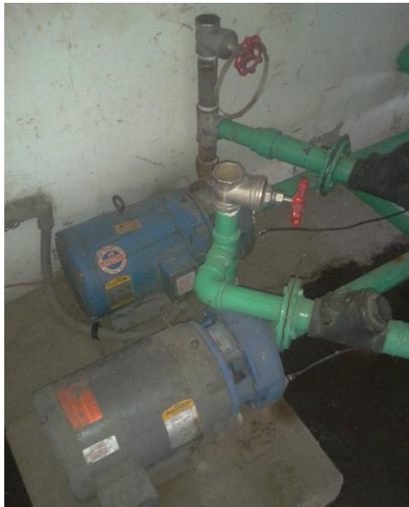
Figura 61. Bombas de Dosificación.
