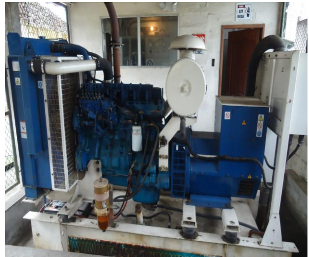
Figura 31. Generador de Emergencia.
