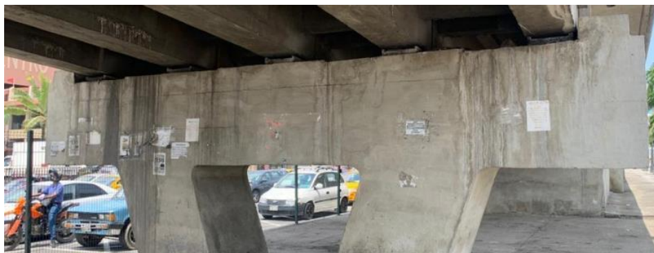
Ilustración 12. Viga cabezal de la pila #2. Fuente: Elaboración propia de autor.
