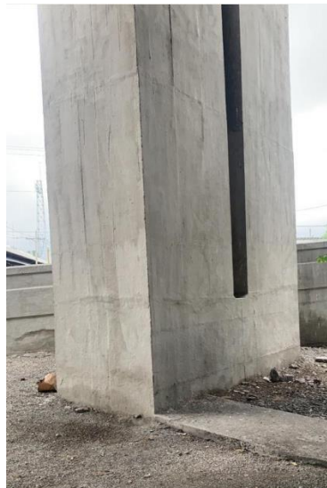
Ilustración 10. Pila #15 del paso elevado con columna rectangular recta. Fuente: Elaboración propia de autor.
