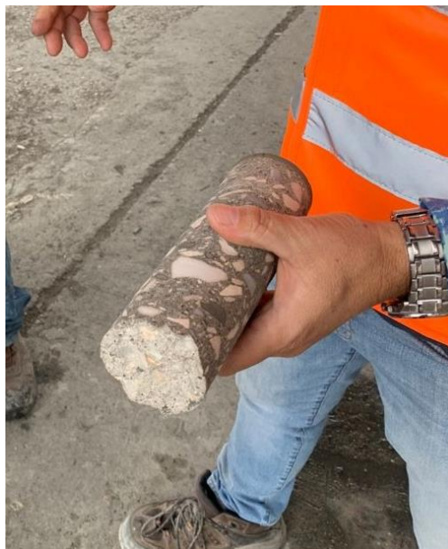
Ilustración 38. Extracción de núcleo de hormigón. Fuente: Elaboración propia de autor.
