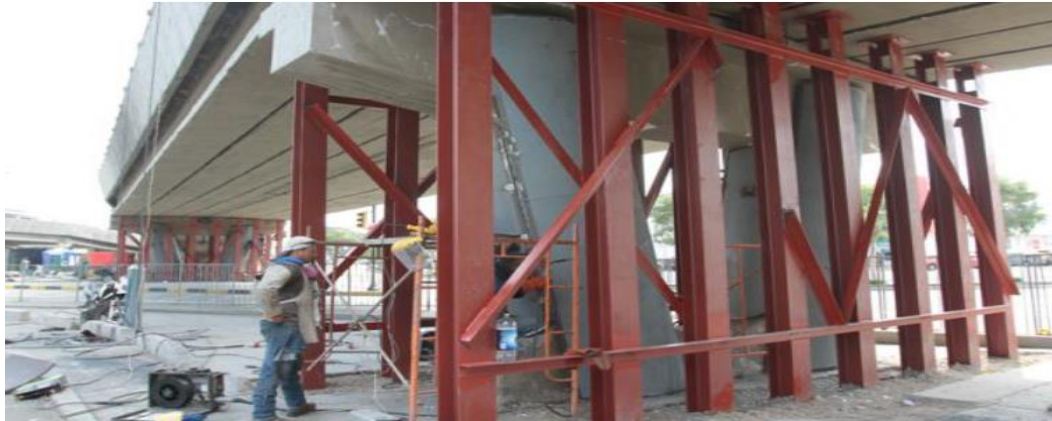
Ilustración 8. Los pilares del paso a desnivel de la intersección de la Av. de Las Américas con la Av. Kennedy fueron apuntalados con perfiles de hierro y son encamisados con acero. Extraído del diario El Universo, 2016.
