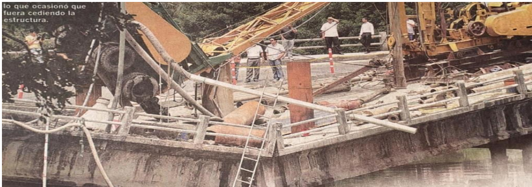
Ilustración 29. Puente Colapsado. Extraído del diario El Universo, 2010.
