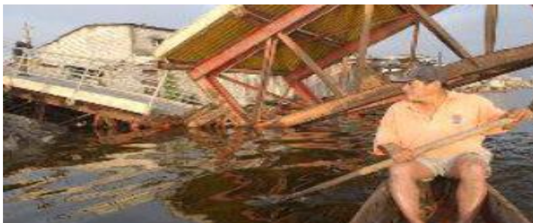
Ilustración 31. Puente colapsado peatonal del estero salado a la altura del estadio de Barcelona s.c. Extraído del diario El Universo, 2005.
