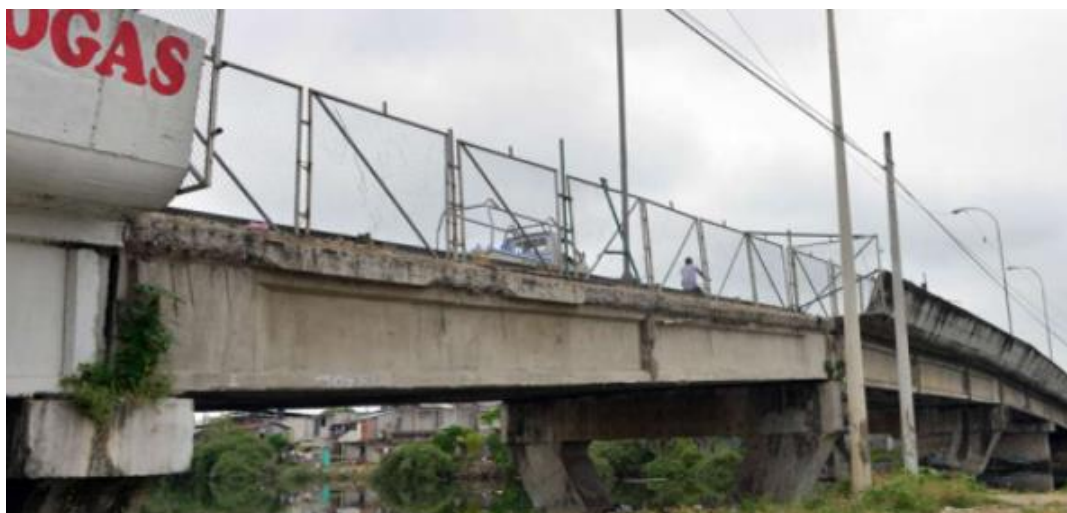
Ilustración 48. Parte del muro lateral que colapsó del puente de la calle G. Extraído del diario el Telégrafo.
