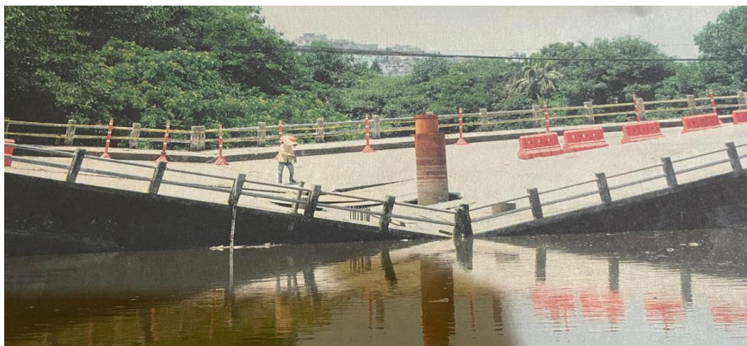
Ilustración 49. Colapso del puente que conecta la Av. Las Monjas con la Av. Carlos Julio Arosemena. Extraído del diario El Universo.
