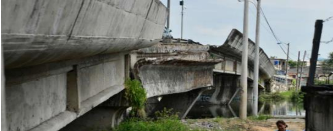
Ilustración 35. Deterioro del Puente de la G. Extraído del diario EL Telégrafo, 2017.
