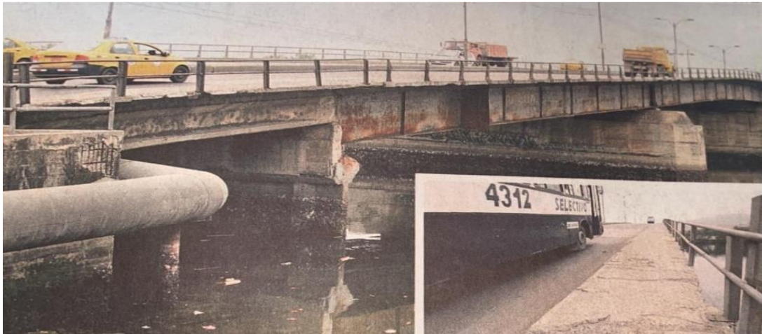
Ilustración 10. Puente de la Calle Portete presenta oxidación en algunas de sus áreas la capa de hormigón está separados en varios tramos. Extraído del diario El Universo, 2010.
