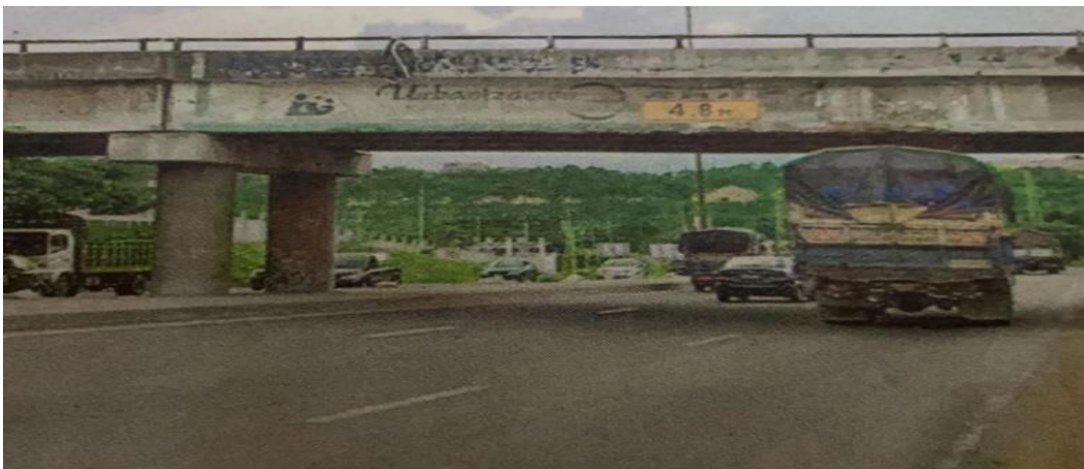
Ilustración 14. El resquebrajamiento en la parte inferior de la viga central. Extraído del diario el Expreso, 2011.
