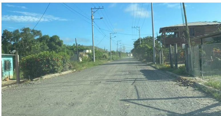
Figura 11. Carretera lastrada por la otra vía que va desde Calderón hasta Caimito, foto tomada en visita técnica el día 04 de junio de 2021.
