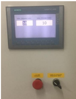
Figura 37 Sistema de control HMI
