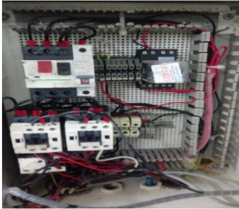
Figura 46 Panel Eléctrico de Elevador de Coches
