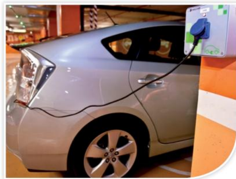
Figura 4. 4: Recarga de vehículos eléctricos en Parque Tecnológico de Barcelona. Fuente: Circuitor.
