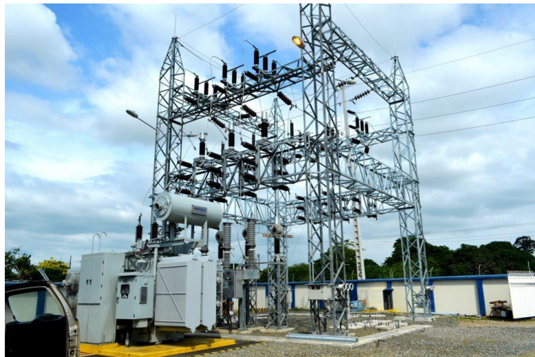
Figura 2. 1. Subestación eléctrica “El Bosque”, Machala, El Oro.
