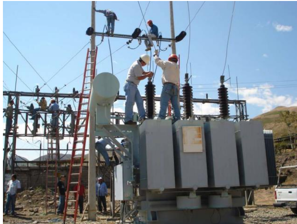
Figura 2. 3. Transformador de Potencia de 5/ 6.25 MVA en Subestación de El Pache, El Oro.
