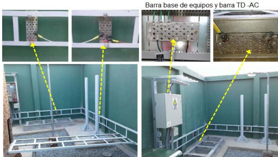
Figura 4. 7 Sistema de barras de una radiobase
