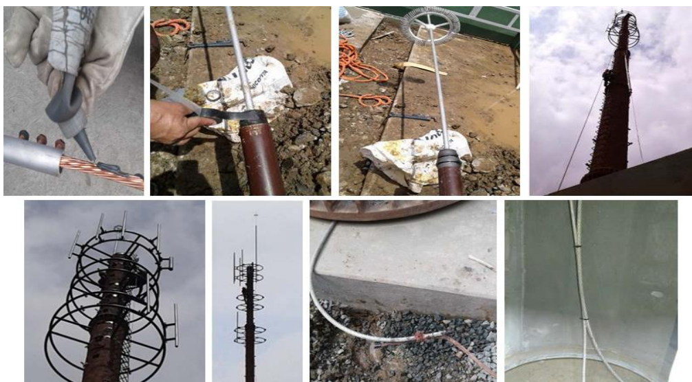
Figura 4. 10 Instalaciones de pararrayos tipo ionizante marca Parres
