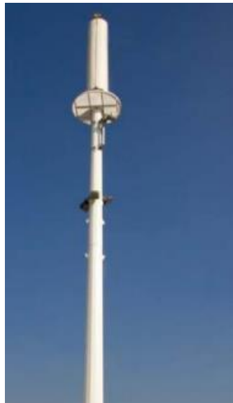
Figura 3. 4 Mimetización tipo poste metálico
