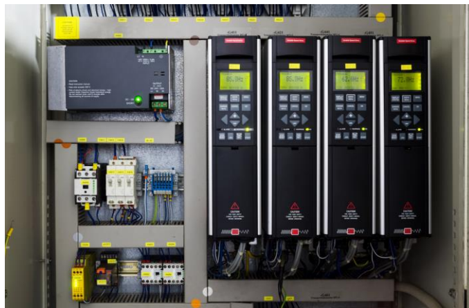
Figura 2. 1 Tableros con dispositivos electrónicos de control y protección
