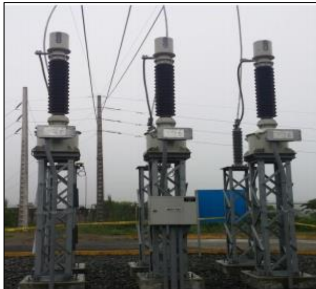
Figura 2. 13. Transformadores de Potencial Fuente. (Ledezma, 2017)
