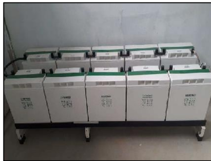
Figura 2. 15. Banco de Baterías Fuente. (Medina, 2018).
