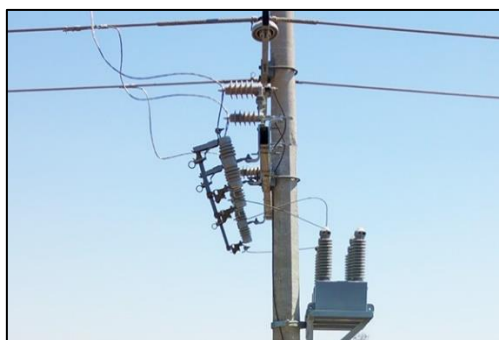
Figura 2. 17. Banco de Capacitores Fijos Fuente. (Equipos para Redes Eléctricas S.A. Eprecsa, 2021)
