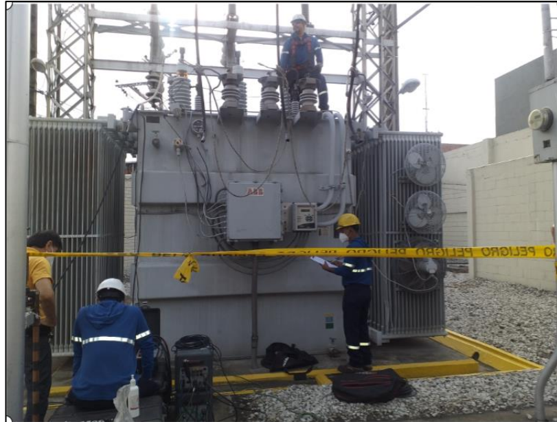
Figura 3. 1. Transformador de Poder S/E Alborada 1 Fuente: El autor, (2021)
