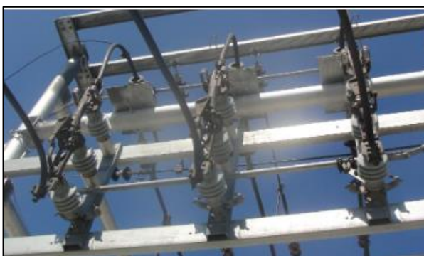
Figura 2. 3. Seccionador de 15 Kv y de transferencia.
