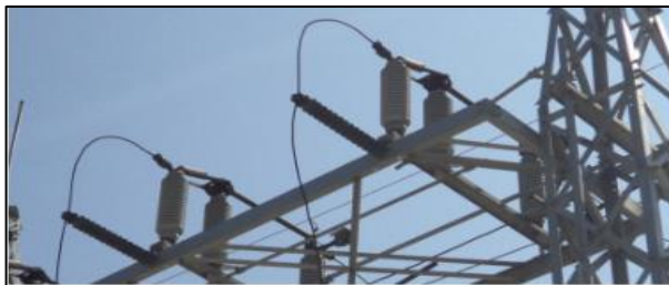
Figura 2. 2. Seccionador de 69 Kv (Soto, 2013)
