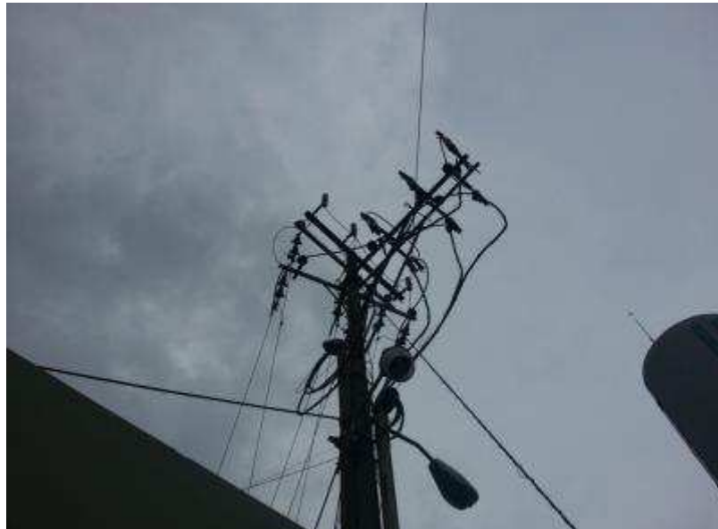
Figura 4.2. Acometida en Media Tensión de la Facultad Técnica.
