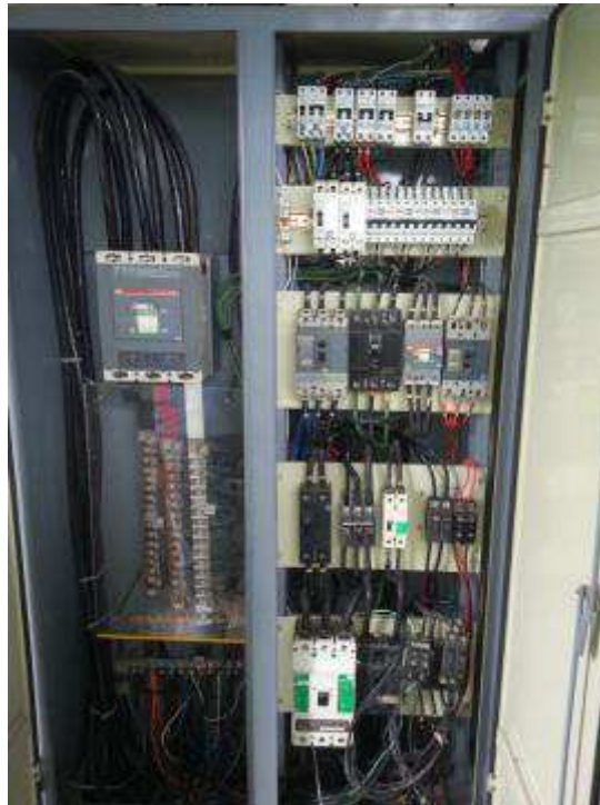
Figura 4.8. Tablero de Distribución Principal de la Facultad Técnica.
