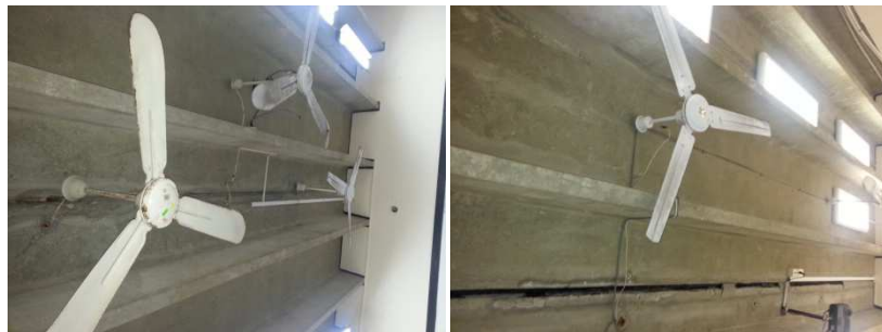
Figura 5.4. Ventiladores en mal estado de la Facultad Técnica.
