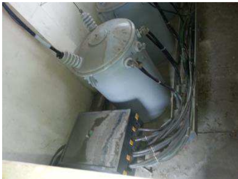
Figura 4.7. Acometida en Baja Tensión de la Facultad Técnica.
