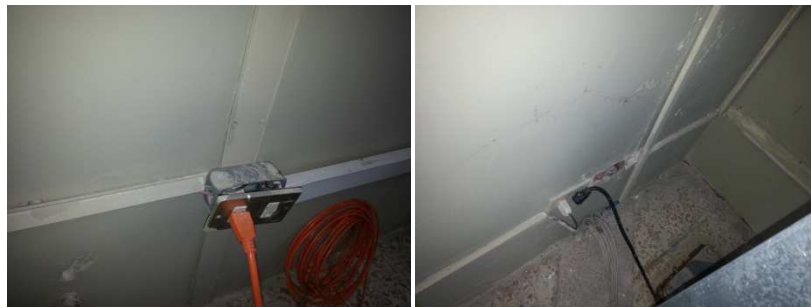
Figura 5.2. Tomacorrientes de 110V en mal estado de la Facultad Técnica.
