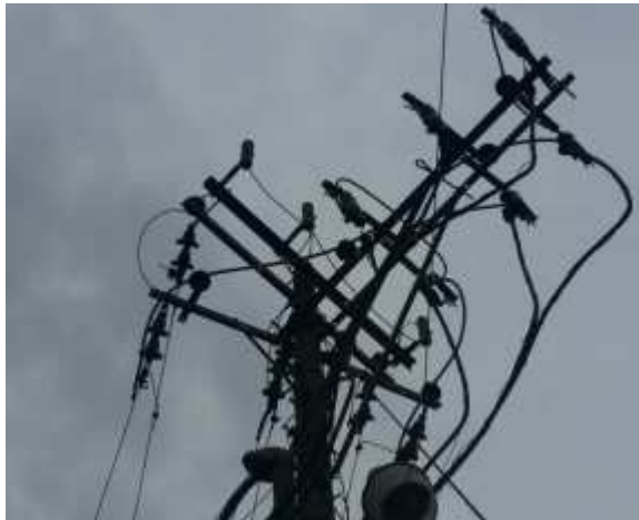
Figura 4.4. Elementos de Protección instalados en el último poste.
