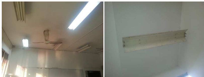
Figura 5.1. Luminarias en mal estado de la Facultad Técnica.
