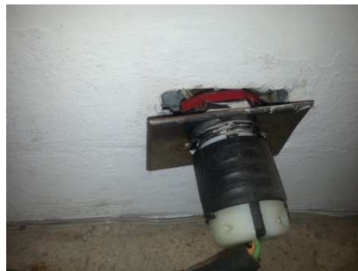
Figura 5.3. Tomacorrientes de 220V en mal estado de la Facultad Técnica.
