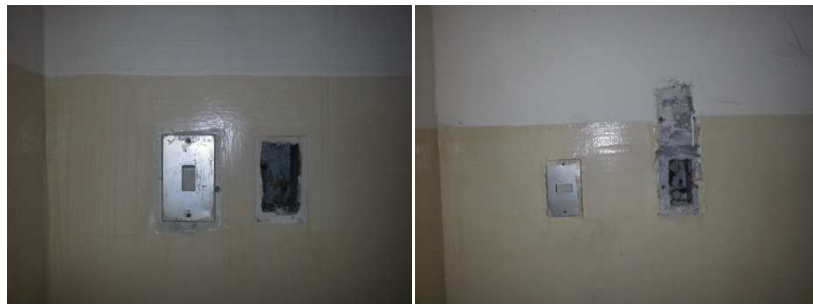
Figura 5.5. Interruptores en mal estado de la Facultad Técnica.
