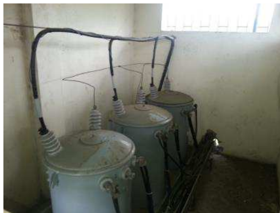
Figura 4.3. Banco de Transformadores de 3x100 KVA de la Facultad Técnica.
