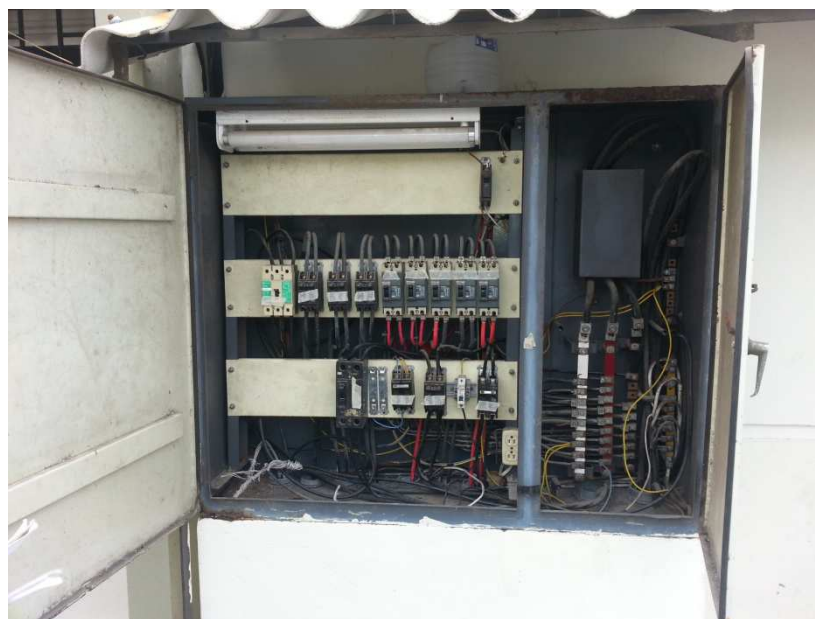
Figura 4.9. Tablero de Distribución Auxiliar de la Facultad Técnica.
