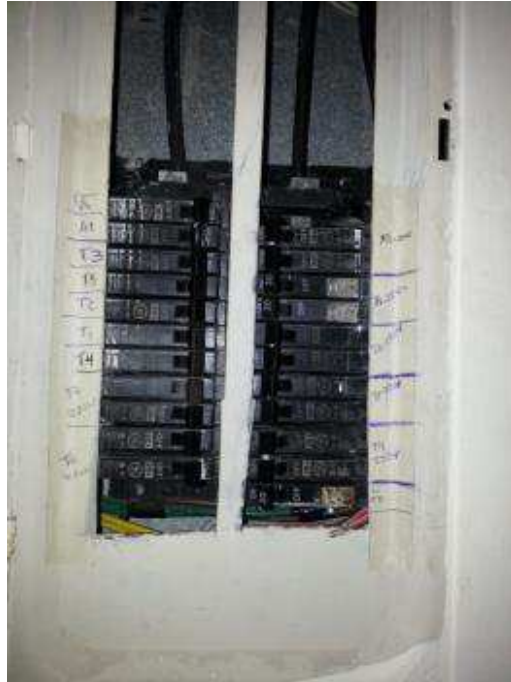
Figura 4.19. PB - Lab.Neu. Ubicado en el Lab. de Neumática de la Facultad.
