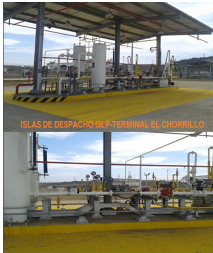
Figura 2.14 Islas de despacho de GLP. Terminal el Chorrillo
