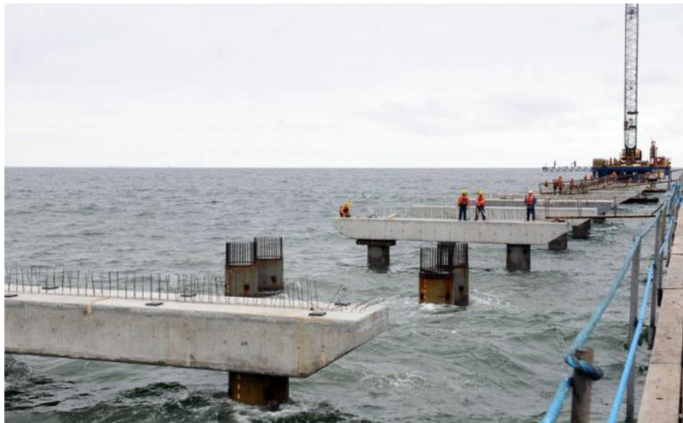
PILOTES DEL MUELLE EN MONTEVERDE
