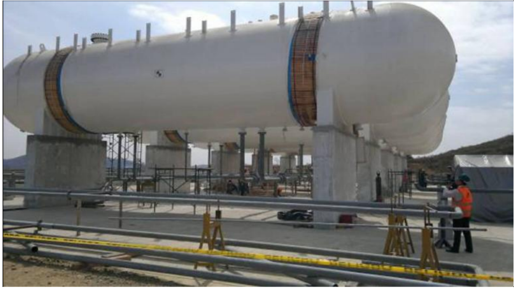
TANQUE HORIZONTAL DE ALMACENAMIENTO GLP EN EL CHORRILLO
