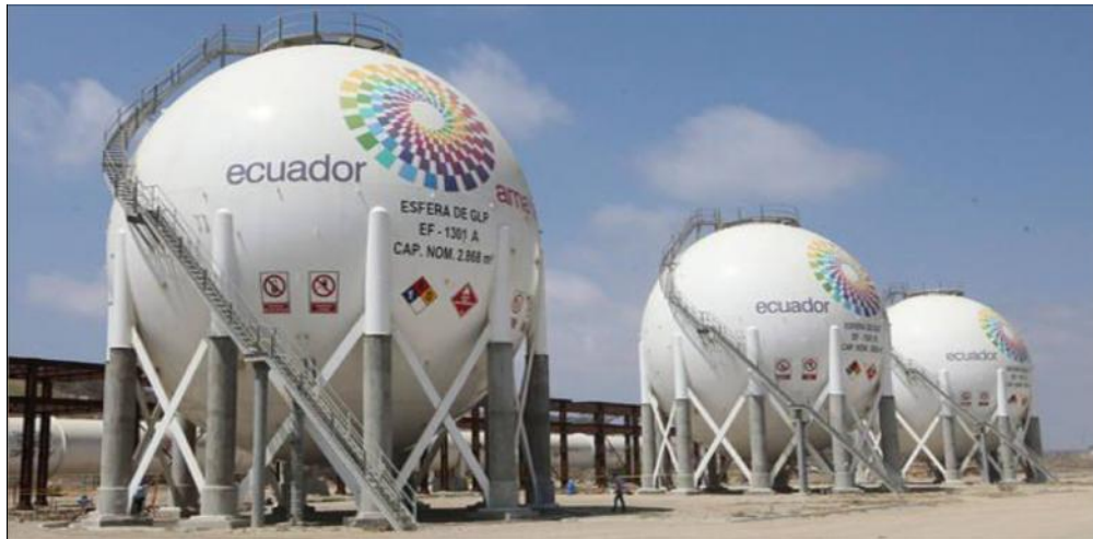
FINALIZACIÓN DE CONSTRUCCIÓN DE ESFERAS DE ALMACENAMIENTO DE GLP EN TERMINAL EL CHORRILLO
