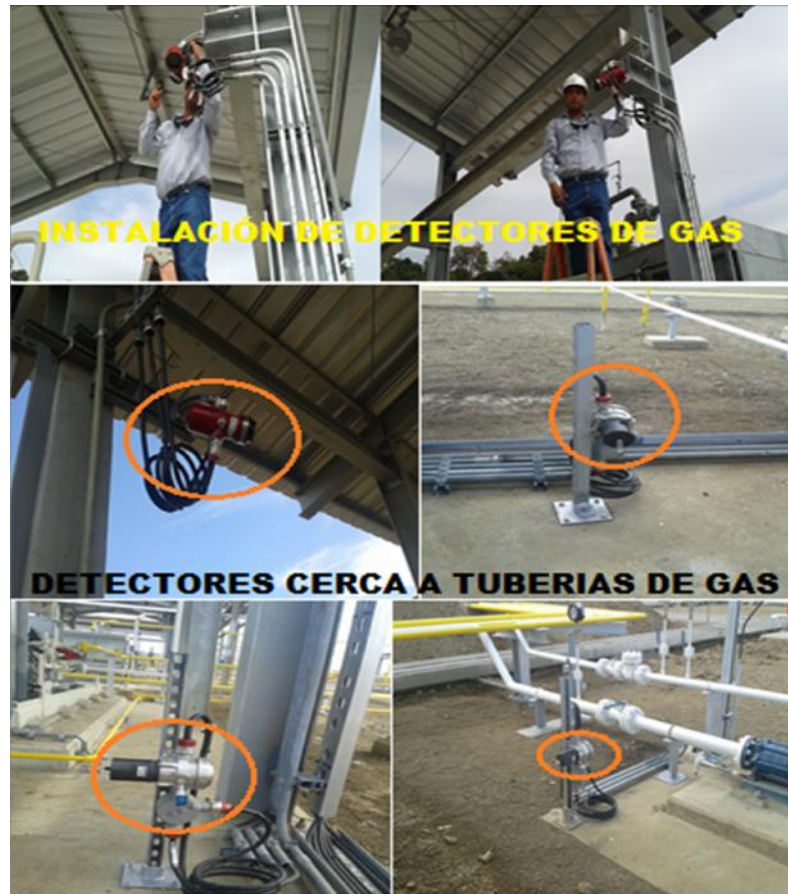
Figura 3.5 Instalación de detectores de gas en islas de despacho en Terminal el Chorrillo
