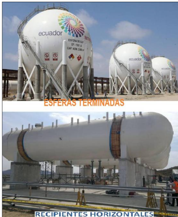
Figura 2.5 Esferas y recipientes horizontales de almacenamiento de GLP Fuente: Conferencia Planta GLP, zona Sur-Ecuador, Bucaramanga, 12 de noviembre de 2013
