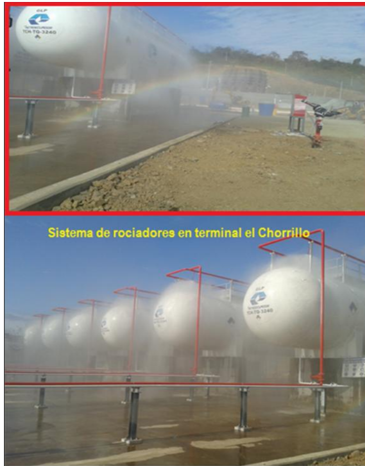
Figura 2.13 Tanques de almacenamiento y sistema de rociadores de agua, en terminal el Chorrillo
