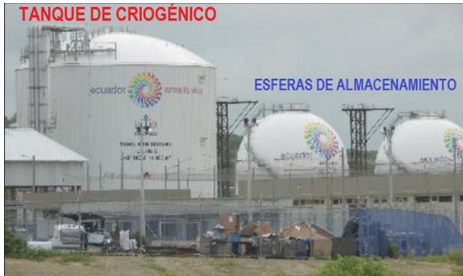
Figura 2.4 Tanque criogénico y esferas de almacenamiento de GLP Fuente: Conferencia Planta GLP, zona Sur-Ecuador, Bucaramanga, 12 de noviembre de 2013. Edición fotográfica por Carlos Medina.
