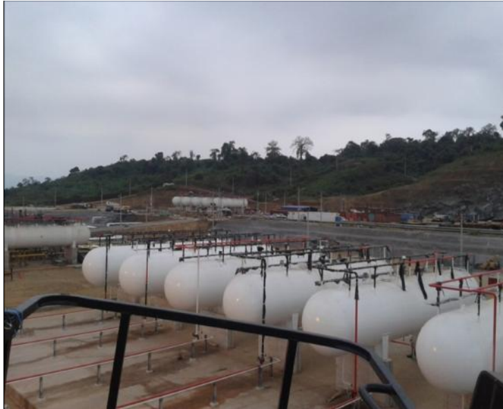
Figura 2.10 Vista de tanques horizontales de almacenamiento GLP
