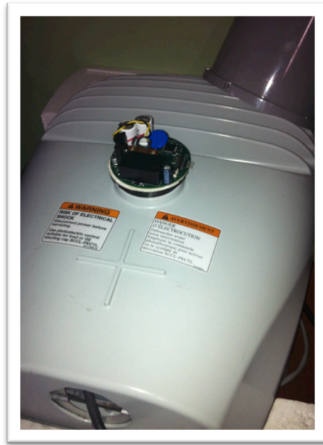
Figura 3.28 Luminaria pública con telecelda expuesta Fuente: Easymetering
