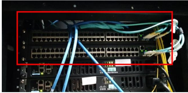
Figura 3. 5: Equipo Rack 8 Fuente: Autor
