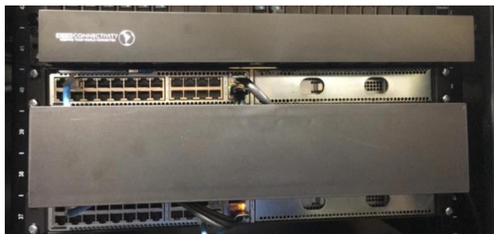
Figura 3. 9: Equipo Rack 2 Fuente: Autor
