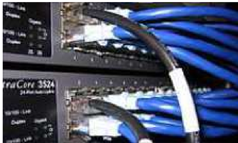
Figura 5.11.2 Imagen hardware comúnmente usado en una red Ethernet
