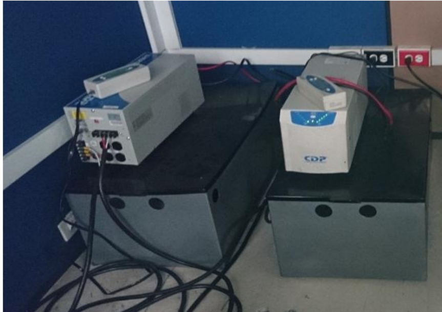
Figura 3.13 Banco Bateria Azotel S.A
