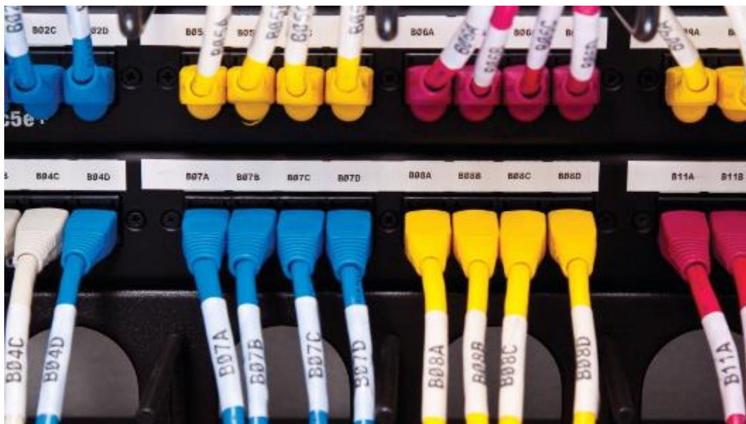
Figura 2.6 Rotulado y Etiquetado de componentes del cableado
