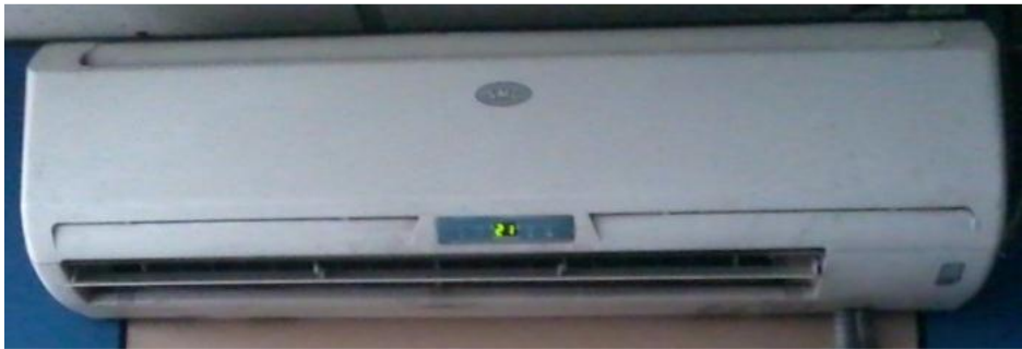
Figura 3.10 Aire Acondicionado sala de Telecomunicaciones
