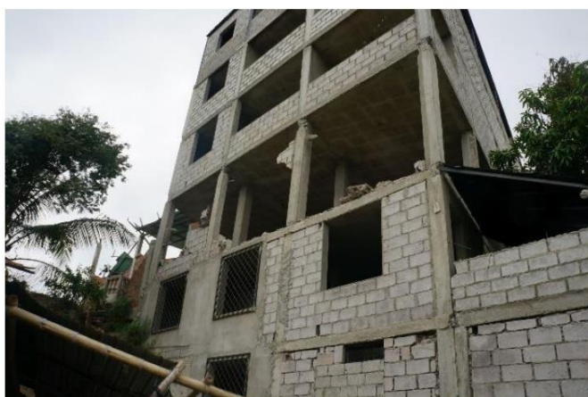
Figura 25: Edificio Miranda Banchón después del sismo
