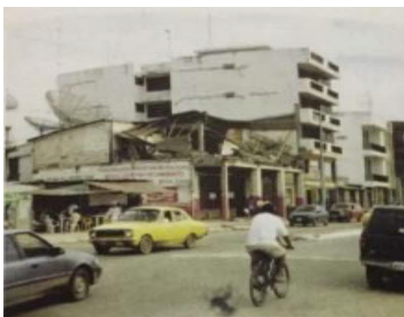
Figura 8: Severos daños en la Edificación del Cuerpo de Bomberos de Bahía de Caráquez
