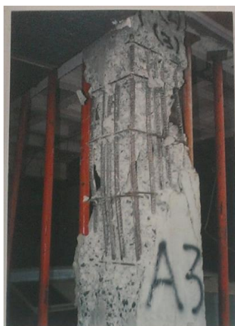
Figura 7: Columna que sufrió mayor daño por falta de refuerzo transversal
