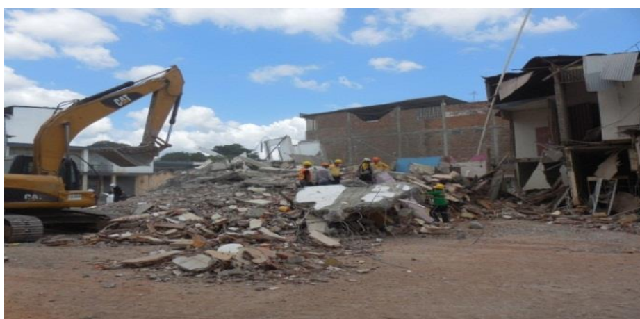
Figura 16: Hotel Cabrera después del sismo del 16 de abril
