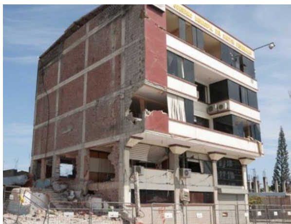
Figura 26: Edificio del GAD de Pedernales después del sismo
