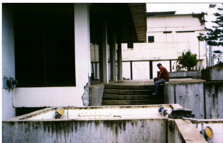
Figura 5: Asentamiento en escalera de acceso del Banco Central el cual no fue asentado sobre pilotes.
