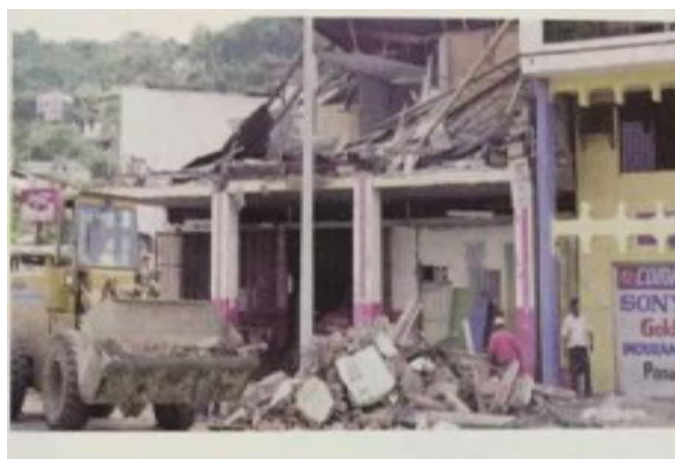
Figura 9: Daños en la fachada del Cuerpo de Bomberos de Bahía de Caráquez
