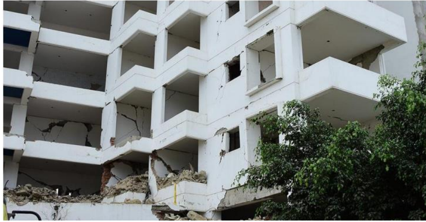
Figura 30: Edificio El Almirante después del sismo - sección interior del inmueble
