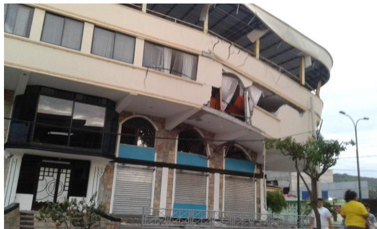
Figura 20: Edificio del Sr. Pedro Ramírez después del sismo del 16 de abril
