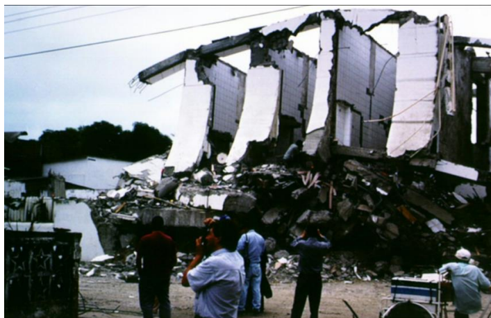
Figura 3: Vista del Edificio Calipso de H.A. de seis pisos que colapsó en sismo de Bahía de Caráquez Fuente: Alva, 2020
