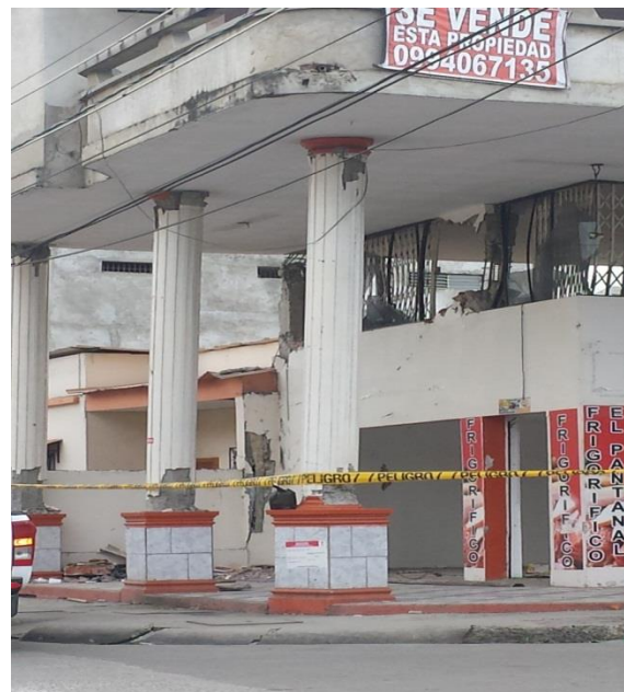
Ilustración 44 Daño en los extremos de columnas exteriores del Edificio Fábrica de Muebles
