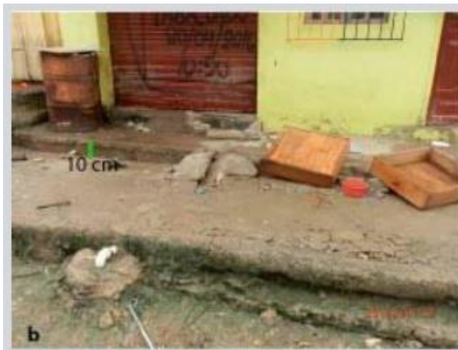
Ilustración 8 Muestra desplazamiento vertical que generó la estructura, en algunas de las casas ubicadas en esta zona, el desplazamiento vertical es variable, entre 10 a 15 cm. La dirección promedio de la falla es N 20°
