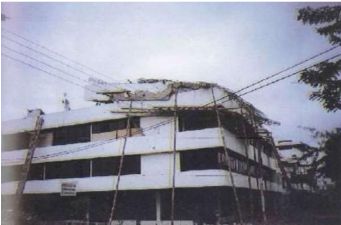
Ilustración 27 Colapso de las plantas superiores del edificio Mendoza
