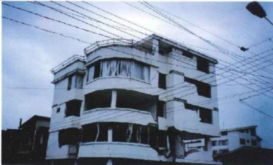
Ilustración 25 Edificio Karina presento fallas en pie y cabeza de columnas
