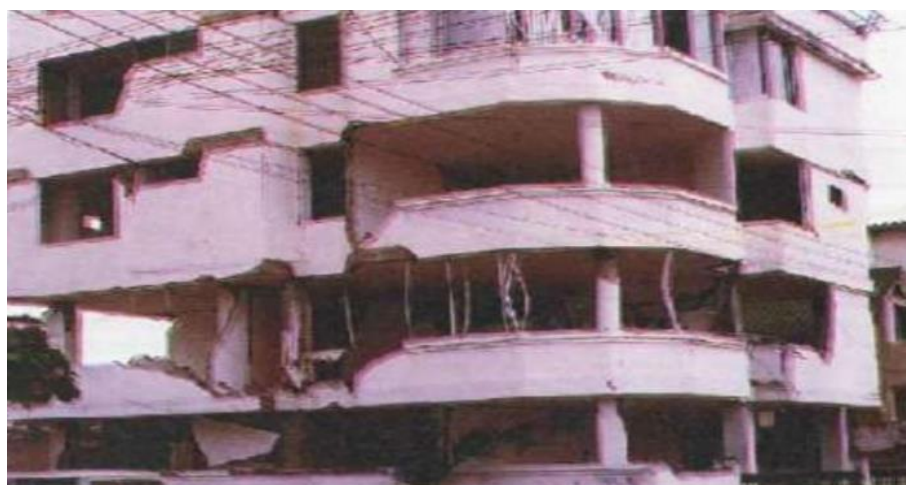
Ilustración 26 Edificio Karina presento fallas en pie y cabeza de columnas
