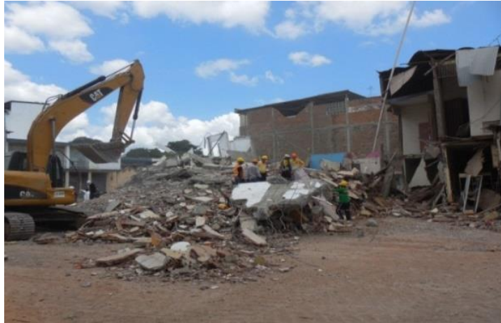
Ilustración 29 Escombros del Hotel Cabrera después del sismos del 16 de abril del 2016
