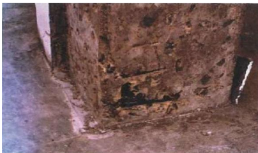
Ilustración 45 Corrosión en el acero de refuerzo en un edificio de la zona turística de Bahía.
