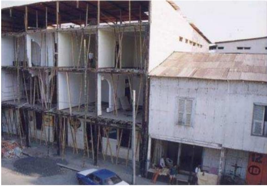
Ilustración 47 Fallas en la edificación por la incompatibilidad de materiales.
