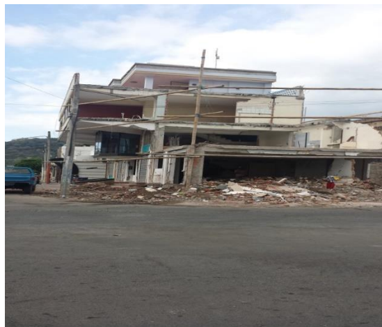
Ilustración 41 Colapso parcial del Edificio Fábrica dtp
