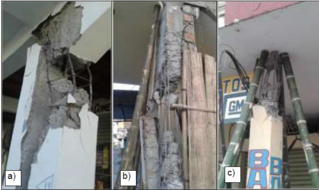
Ilustración 20 Falla por falta de confinamiento en columnas; a) estribos muy separados; b) estribos de 8mm; c) no se aprecia el estribo.
