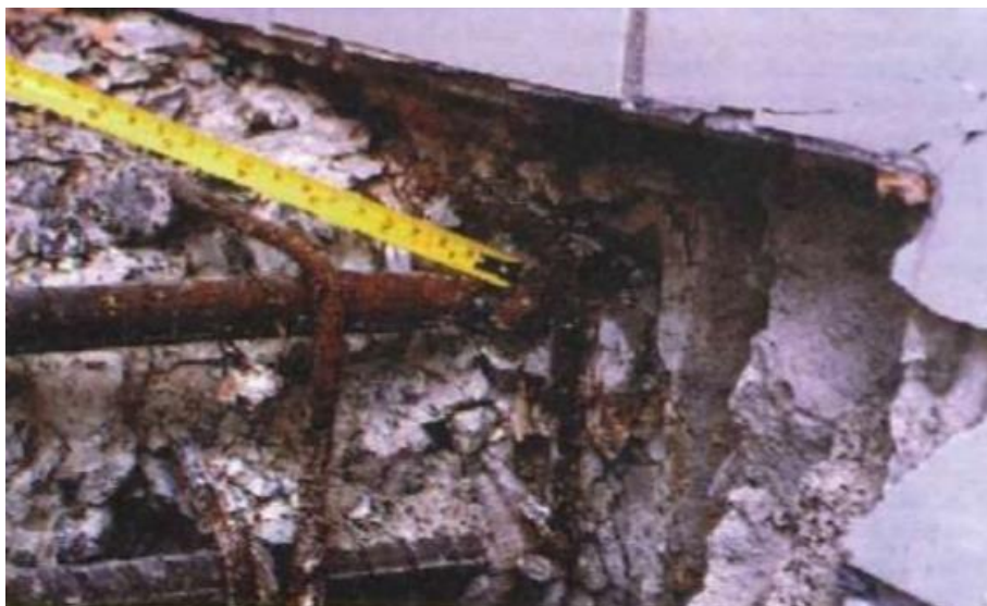
Ilustración 46 Rotura de varillas por corrosión en el edificio Calipso.
