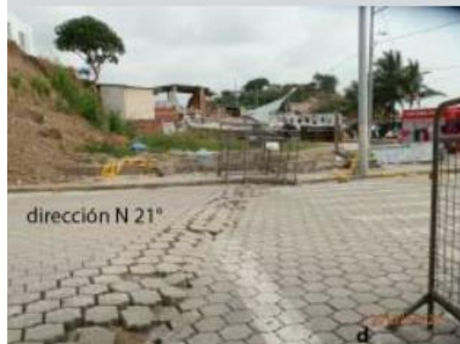
Ilustración 9 Deformación de la falla se manifiesta con plegamiento de las zonas afectadas
