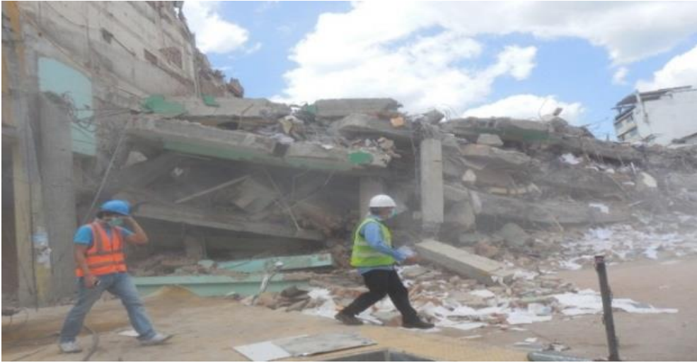
Ilustración 32 Colapso del Edificio IESS después del sismo de 2016
