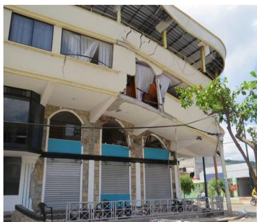
Ilustración 42 Daño estructural en el Edificio Fábrica dtp
