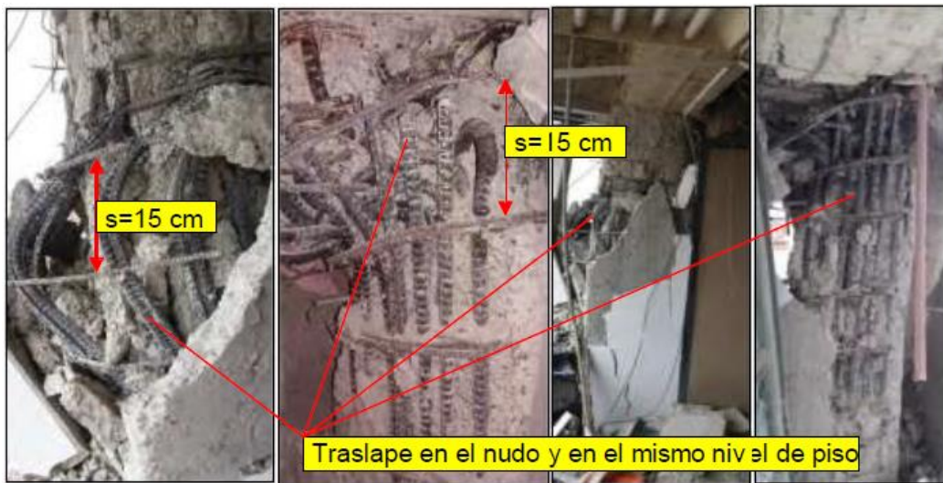
Ilustración 19 daños en columnas del quinto piso del edificio Mutualista Pichincha.
