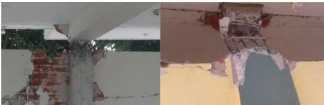
Ilustración 4 Daño por columna corta registrado en edificaciones de Portoviejo.
