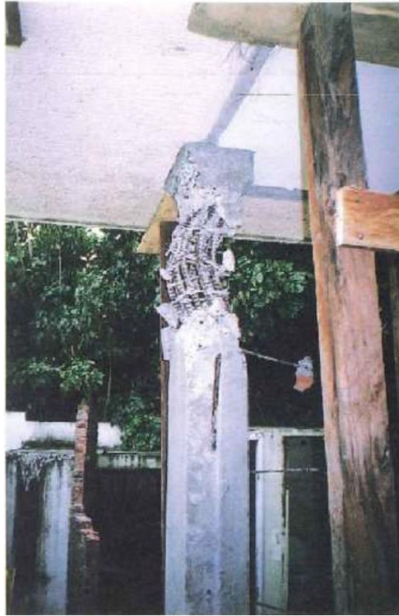
Ilustración 21 daño típico de una columna del edificio Los Corales
