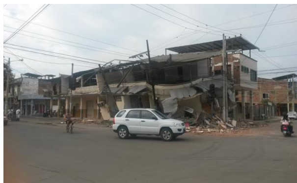
Ilustración 38 Colapso Parcial de la Clínica Yanqui
