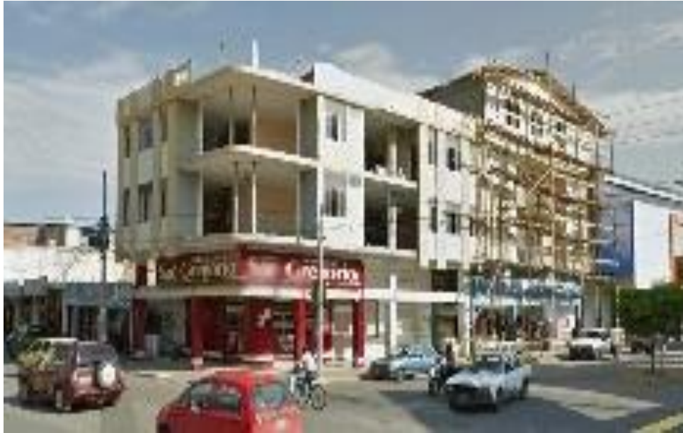
Ilustración 22. Edificio "Farmacia San Gregorio" antes del sismo 16 de abril 2016.
