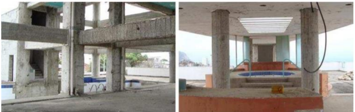
Ilustración 10. Concentración de masas en el edificio Cabo Coral. Izquierda: Piscina en la segunda planta. Derecha: Jacuzzi en la octava planta.
