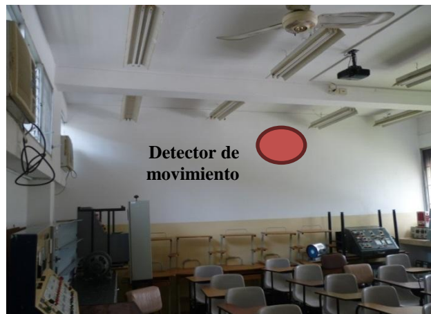
Figura 3.13 Fotografía de la ubicación recomendada del detector de movimiento marca Honeywell modelo 5897-35
