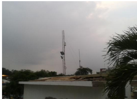
Fig. 3.15: Torre de 6mts de Altura ubicada en la parte superior de la Secretaría de la Facultad Técnica para el Desarrollo Fuente: Autor
