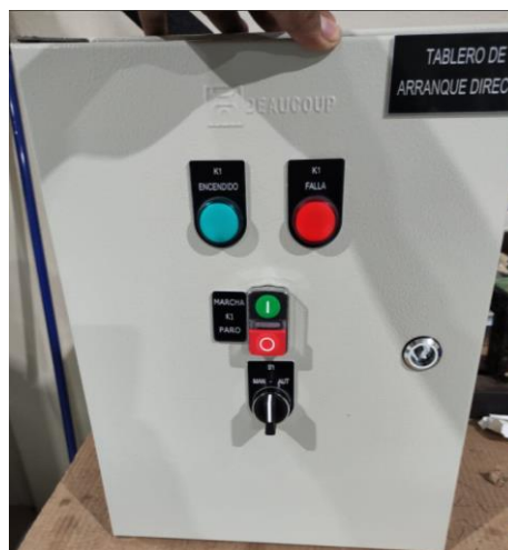
Figura 3.11. Parte externa del tablero de control. Fuente: Elaborado por el autor.
