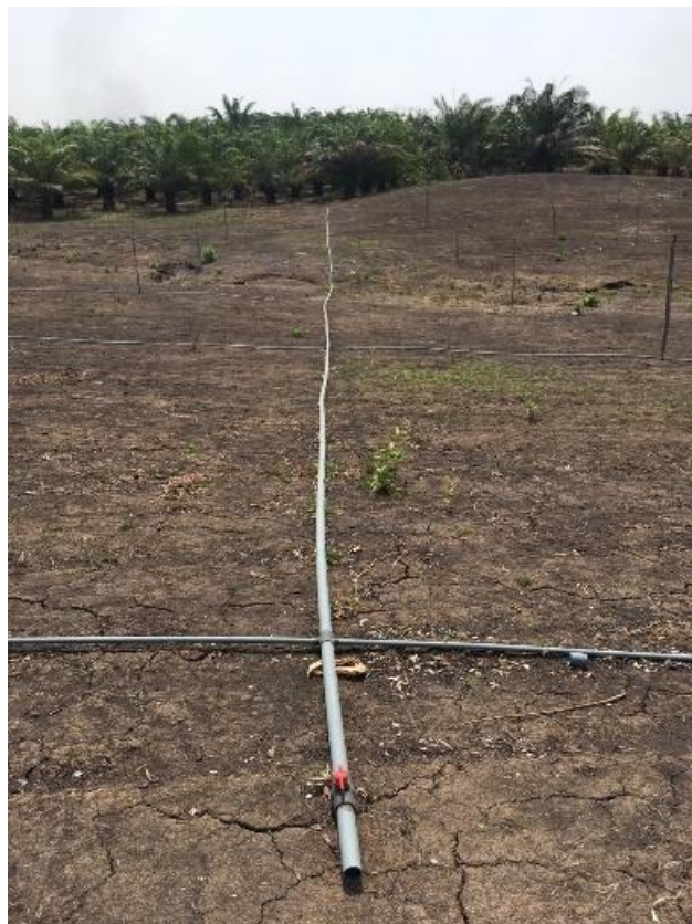
Figura 3.3. Distribución de tubería PVC.
