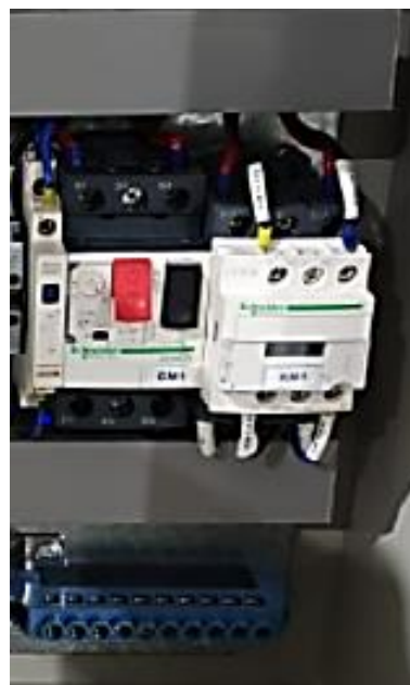
Figura 3.15. Sistema de fuerza implementado. Fuente: Elaborado por el autor.
