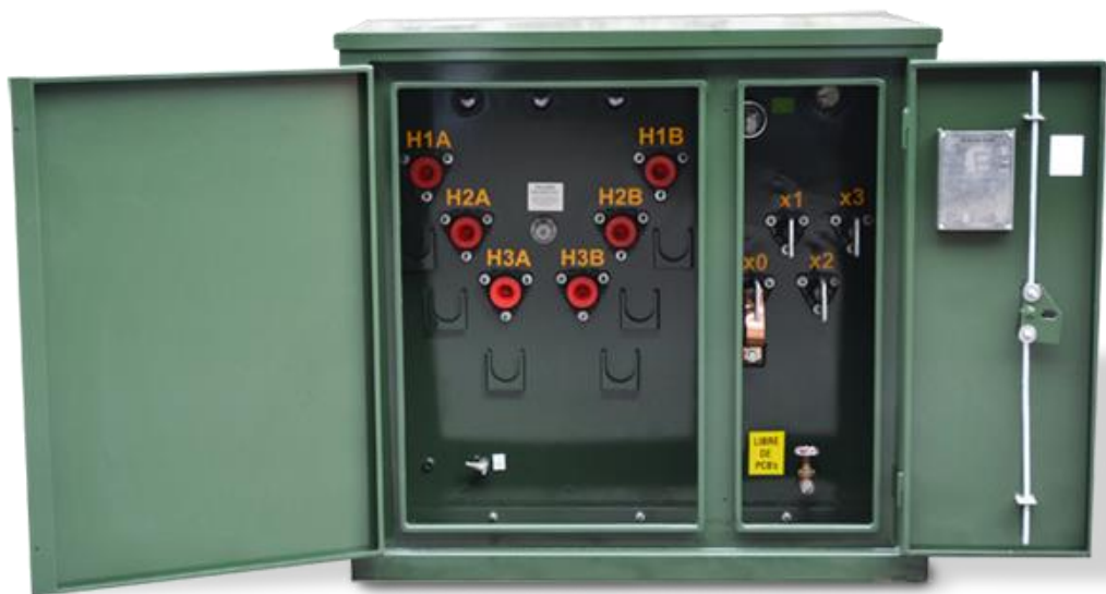
Figura 2.6: Transformador trifásico pad mounted
