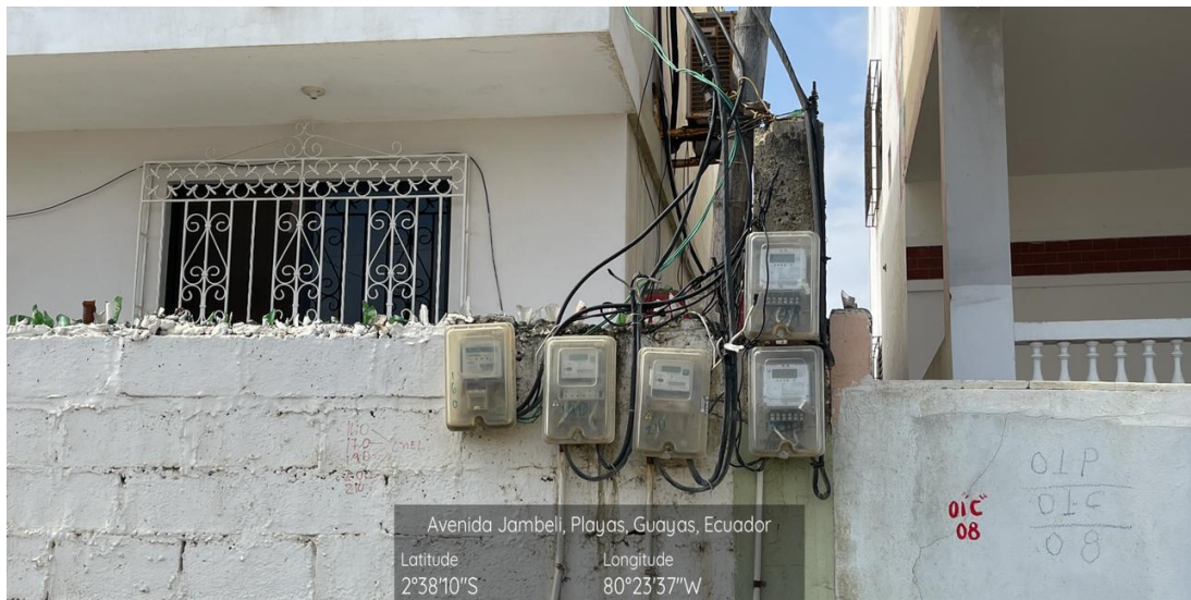
Figura 4.11: Acometidas en la zona residencial del Malecón de Playas Fuente: El autor
