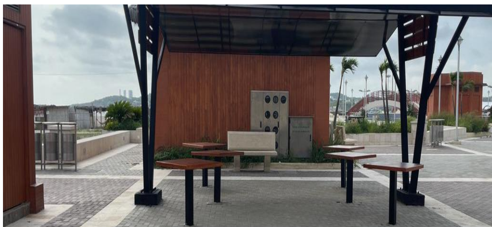
Figura 4.14: Tipo de panel de medidores para modulos 1 y 2 Fuente: El Autor
