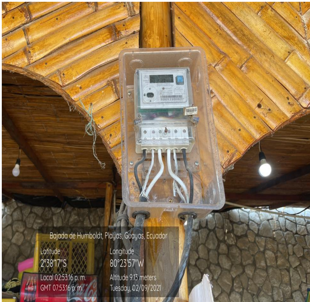
Figura 4.6: Medidor controlador en módulo tipo cabaña 2 Fuente: El autor
