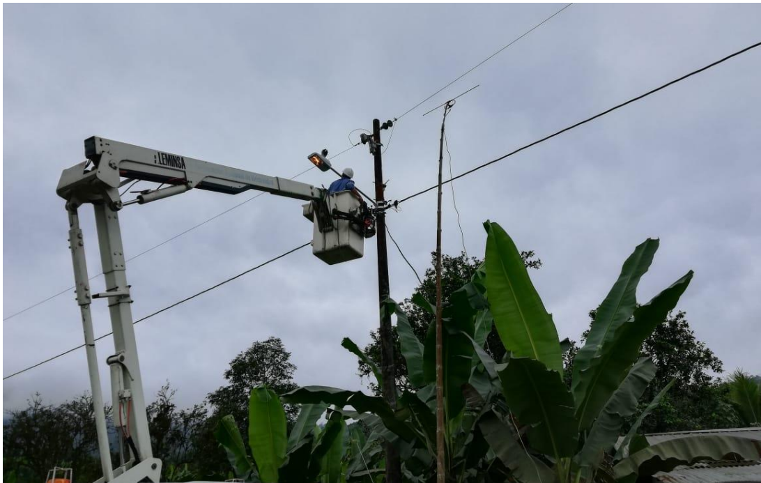
Figura 2.7: Ampliación de redes eléctricas aéreas
