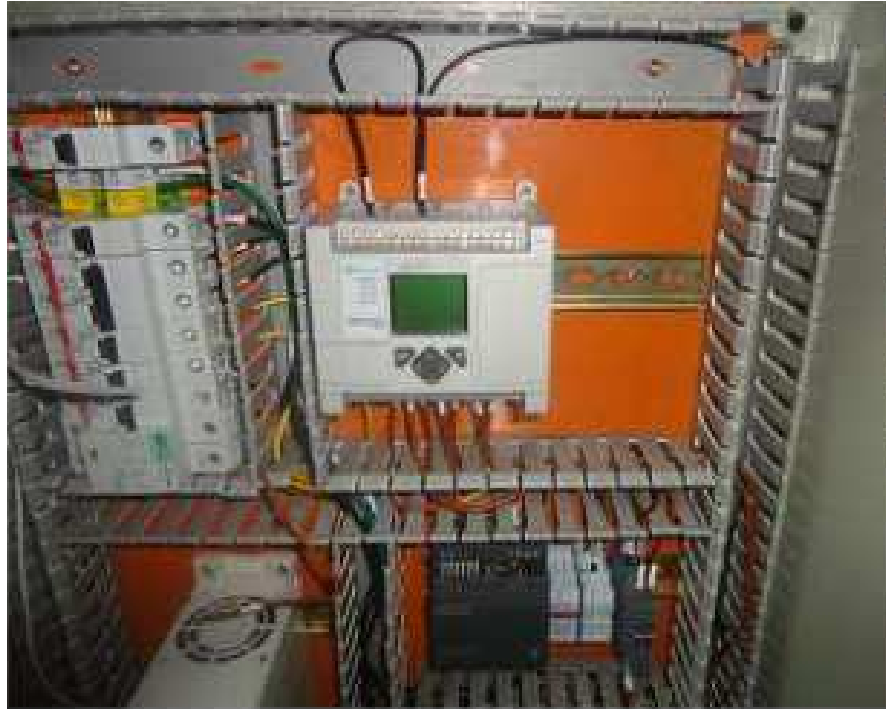
Figura 3.10: Ubicación del PLC Micrologix 1100. Fuente: autores
