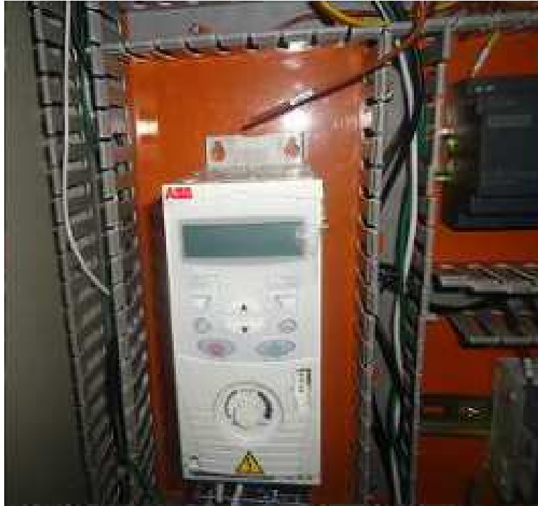
Figura 3.9: Ubicación del variador de frecuencia ABB ACS 150.
