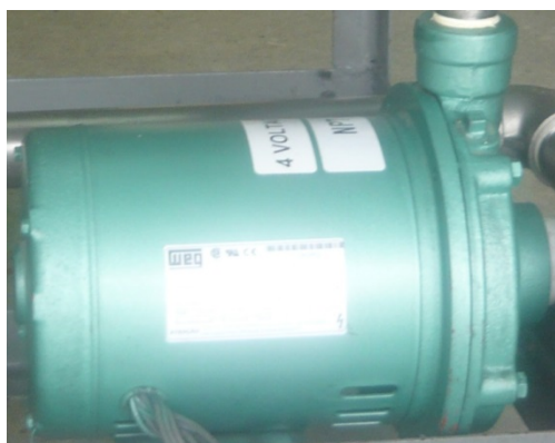
Figura # 3. 15: Bomba centrífuga de 40 GPM con motor WEG de 1/2 HP
