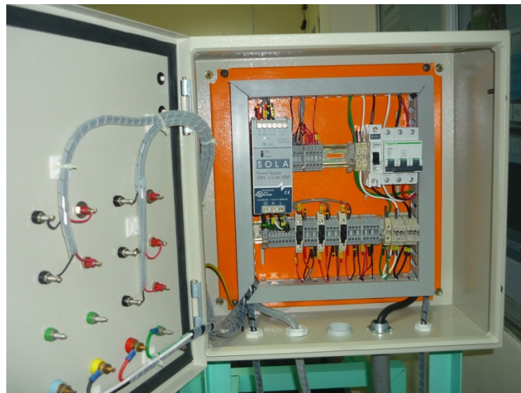
Figura # 3. 19: Muestra el panel con sus componentes y totalmente cableado Fuente: Héctor Galvis y Humberto Zeas
