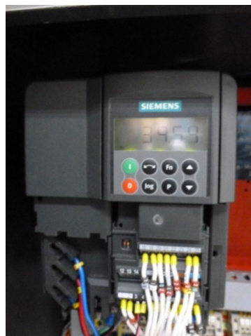
Figura # 4. 17: Panel del Variador con salida de frecuencia de 39.59hz Fuente: Héctor Galvis y Humberto Zeas
