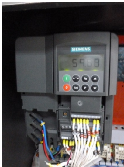
Figura # 4. 23: Panel del Variador con salida de frecuencia de 59.88hz Fuente: Héctor Galvis y Humberto Zeas
