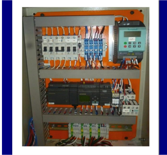
Figura 4. 21 Imagen frontal de los elementos en general Fuente: Tablero Didáctico
