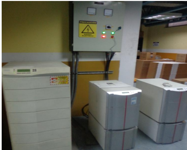
Figura 28: Cuarto de UPS de Gráficos Nacionales S.A.
