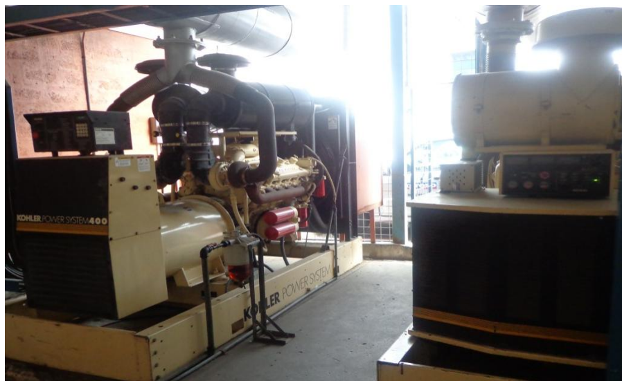
Figura 27: Descripción de los generadores.
