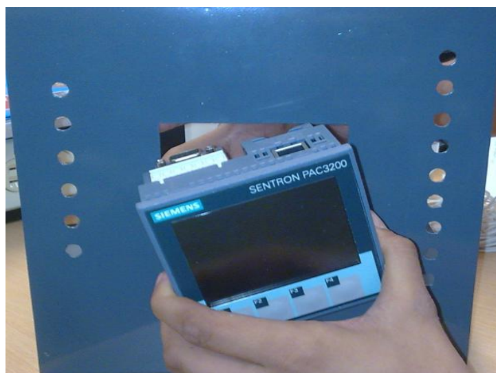
Figura 38: Montaje del SENTRON PAC 3200 en el panel frontal.
