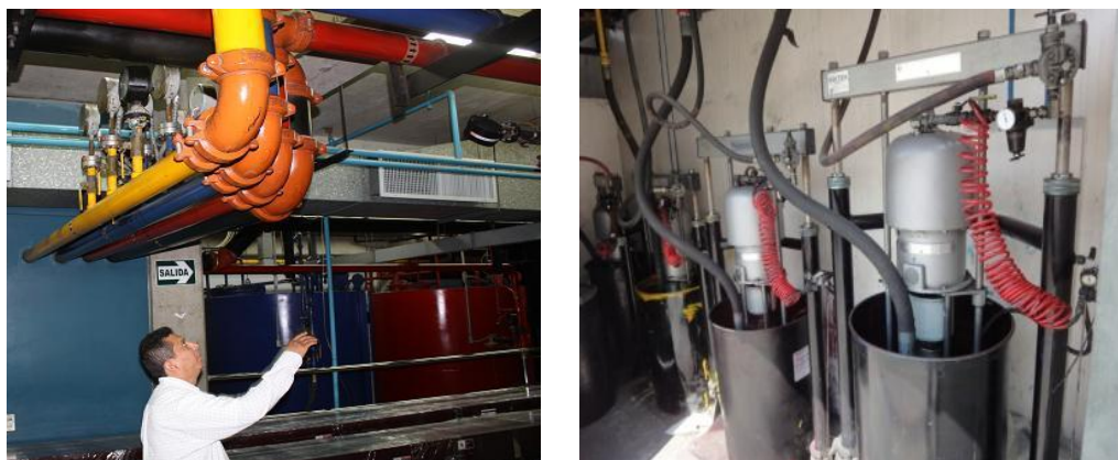
Figura 3: Tuberías de tinta y bombas de tinta.
