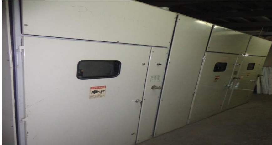
Figura 23: Cuarto de celdas.
