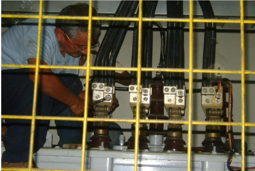
Figura 26: Desconexión, limpieza y reconexión de los terminales de Media y Baja tensión del transformador de 1000KVA de la Rotativa U70.
