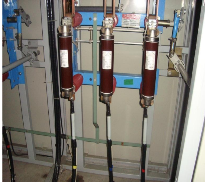
Figura 24: Puntas de media tensión de la celda principal.
