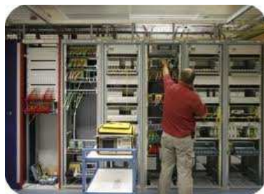
Figura # 3. 9: Cuarto de Equipos Fuente: Autores
