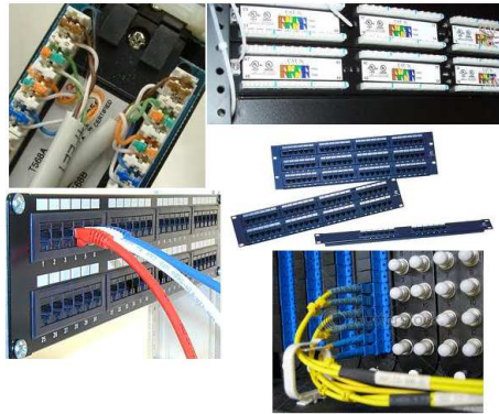
Figura # 3. 4: Bastidores o Patch Panel
