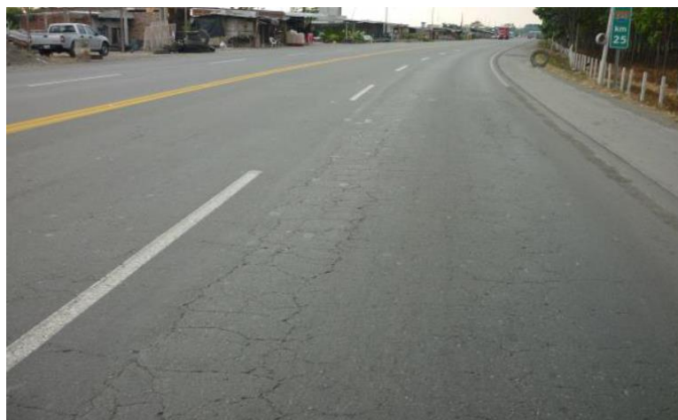
Figura 3.1. Agrietamientos tipo top-down presentes en la vía “Durán-Boliche”
