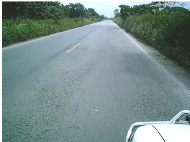
Figura 2.1. Agrietamiento por fatiga tipo piel de cocodrilo. Tomado de materiales de clases de la asignatura Pavimentos. Ing. Rolando Vila. UCSG. 2019.
