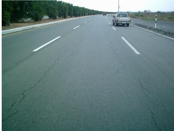
Figura 2.2. Deterioro por TPD en fase de desarrollo. Tomado de materiales de clase de la asignatura Pavimentos. Ing. Rolando Vila. UCSG. 2019.
