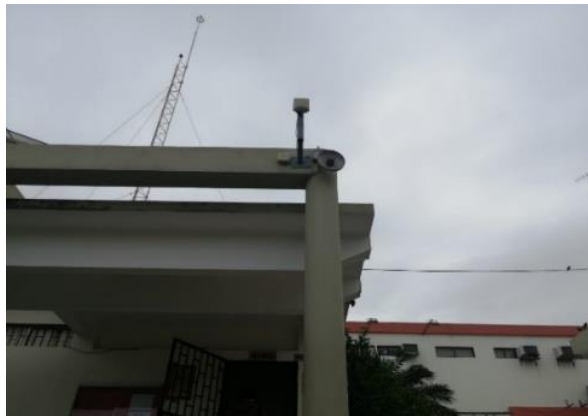
Figura 3. 4: Equipo Access Point externo sobresaliendo del pilar Fuente: El autor
