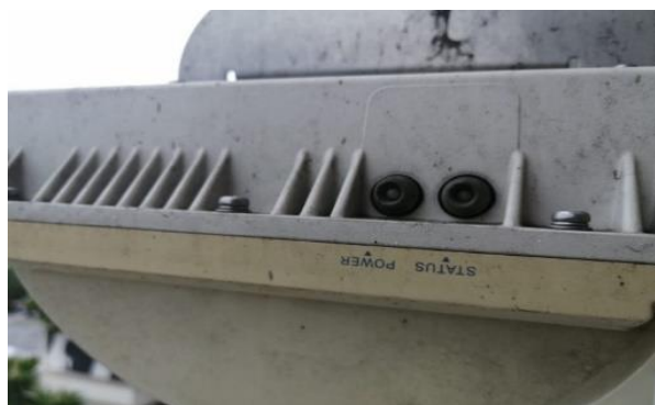
Figura 3. 5: Acercamiento del equipo Access Point externo Fuente: El autor
