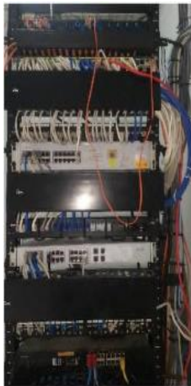
Figura 3. 13: Rack de Acceso del Bloque Administrativo de la Facultad Técnica Fuente: (García Gamboa, 2016)
