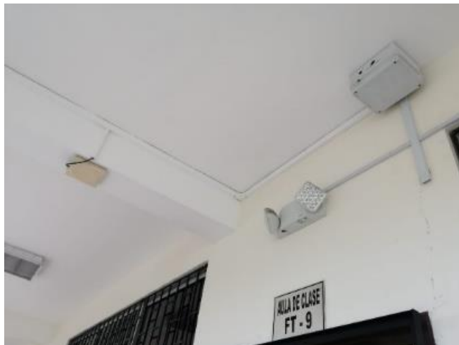
Figura 3. 9: Equipos Access Point Fuente: El autor
