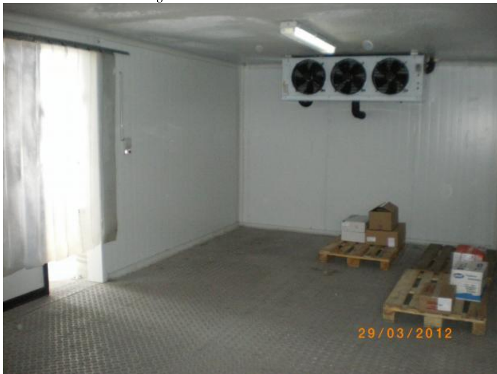
Imagen 13 : Interior de Cámara de Frio
