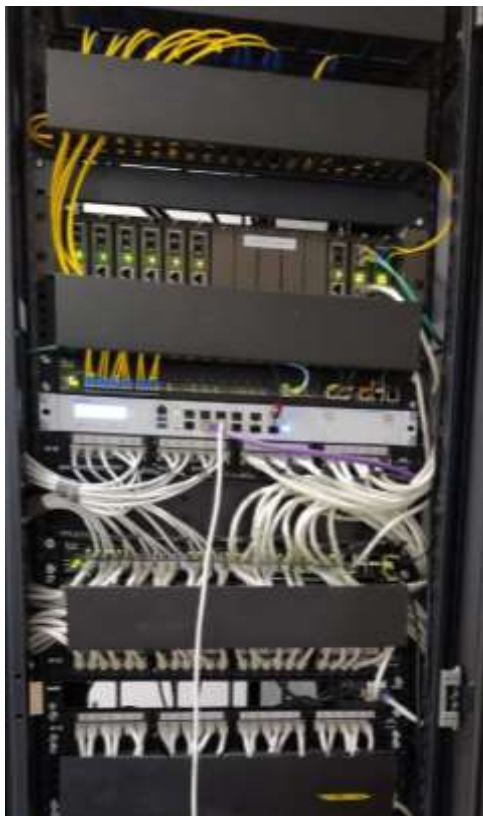
Figura 41: Rack con switch core Fuente: Autor
