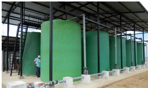
Figura 1. Batería de Tanques
