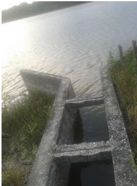
Figura 16 Compuertas de la piscina Elaborado por Andrade & Ostaiza (2020)
