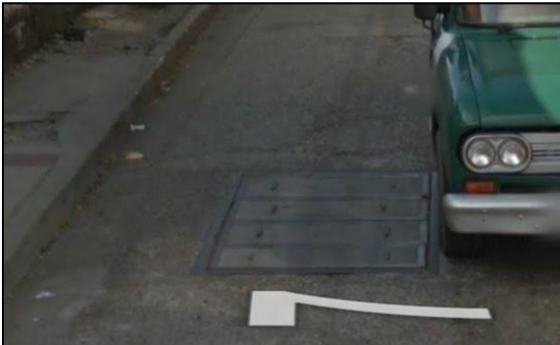
Figura 6 Válvula de abastecimiento ubicada en la Avda. Luis Noboa Naranjo y Avda. Río Amazonas
