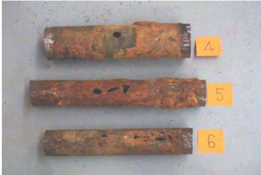
Ilustración 8. Secciones de tuberías de acero corroídas.
